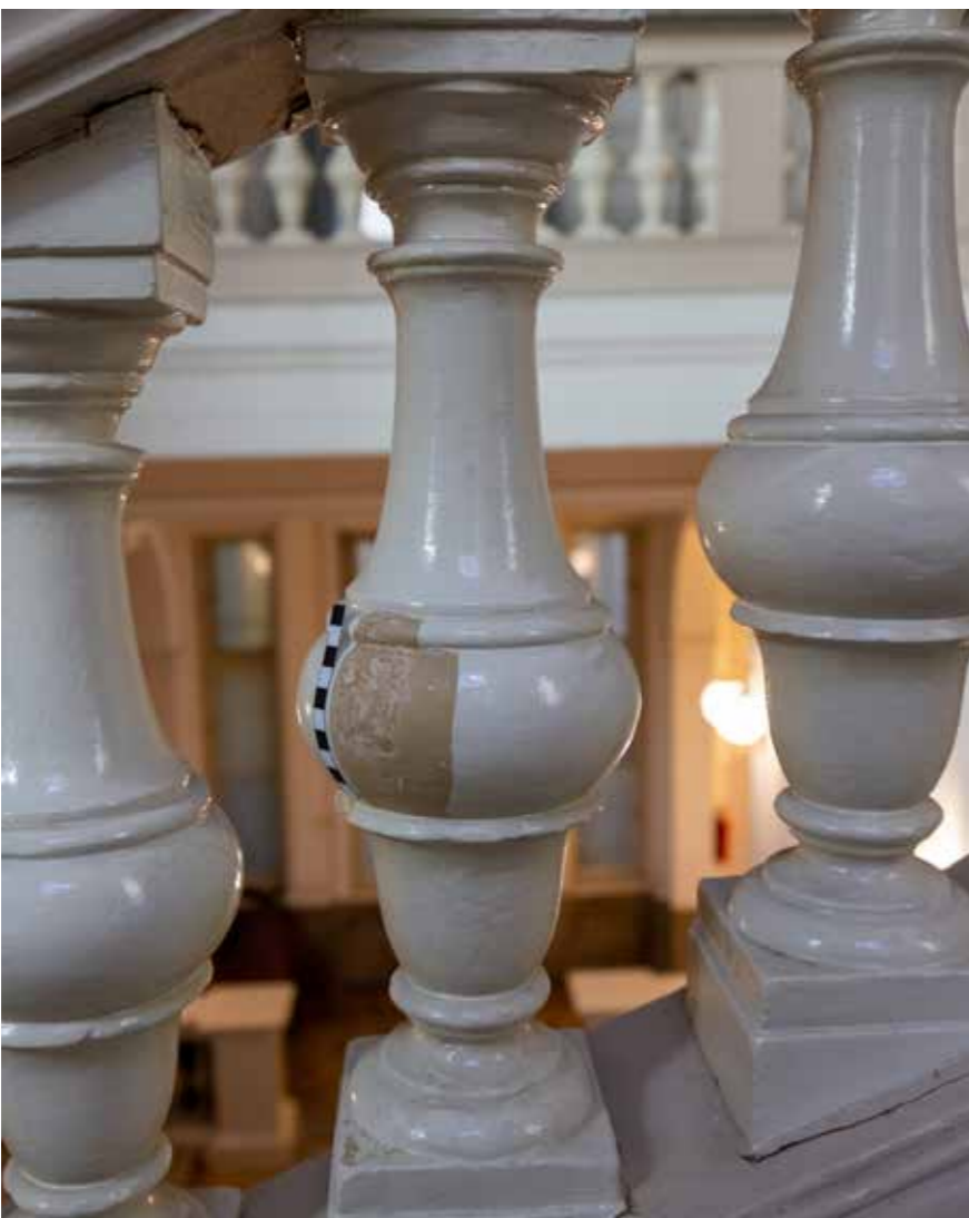
Balustrada stubišta naknadno prebojana uljanom bojom, sonda otkriva izvorni marmorizirani štuko koji treba restaurirati
