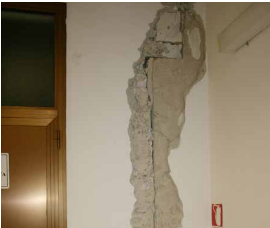
Oštećenja od potresa i neodržavanja zgrade
