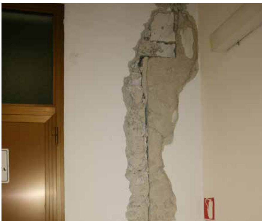
Oštećenja od potresa i neodržavanja zgrade
