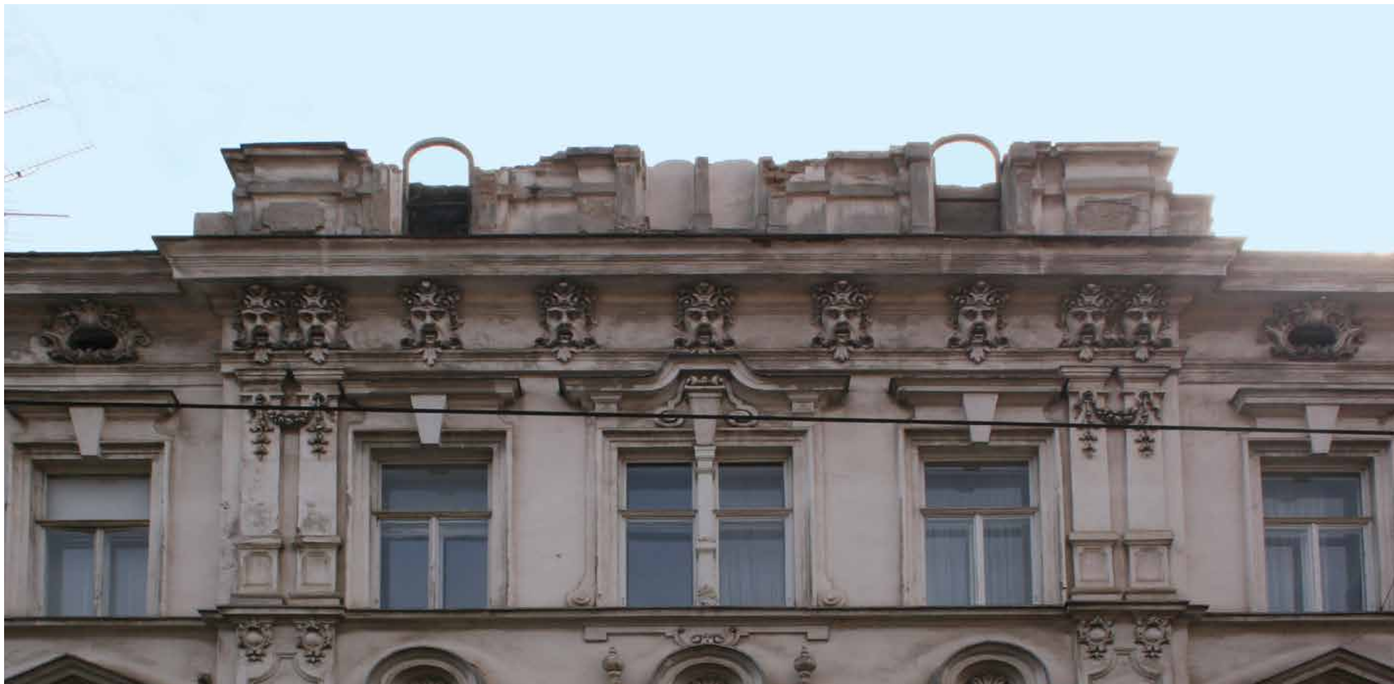
Kuća Hönigsberg, Ilica 53, atika oštećena u potresu 22. ožujka 2020.
