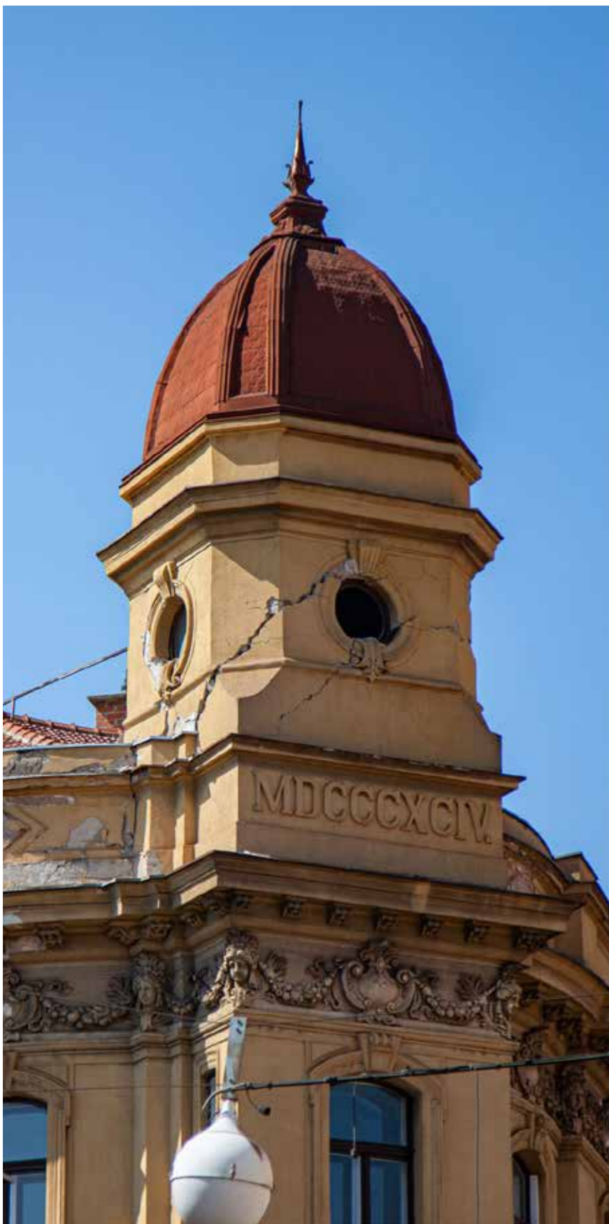
Ugaona kupola s oštećenjima nastalima u potresu 22. ožujka 2020., uklonjena nakon potresa 22. travnja
