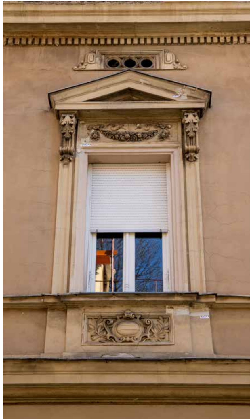
Prozor na prvom katu
