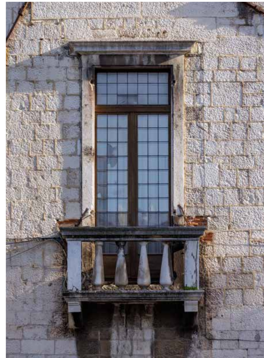
Balkon na prvom katu
