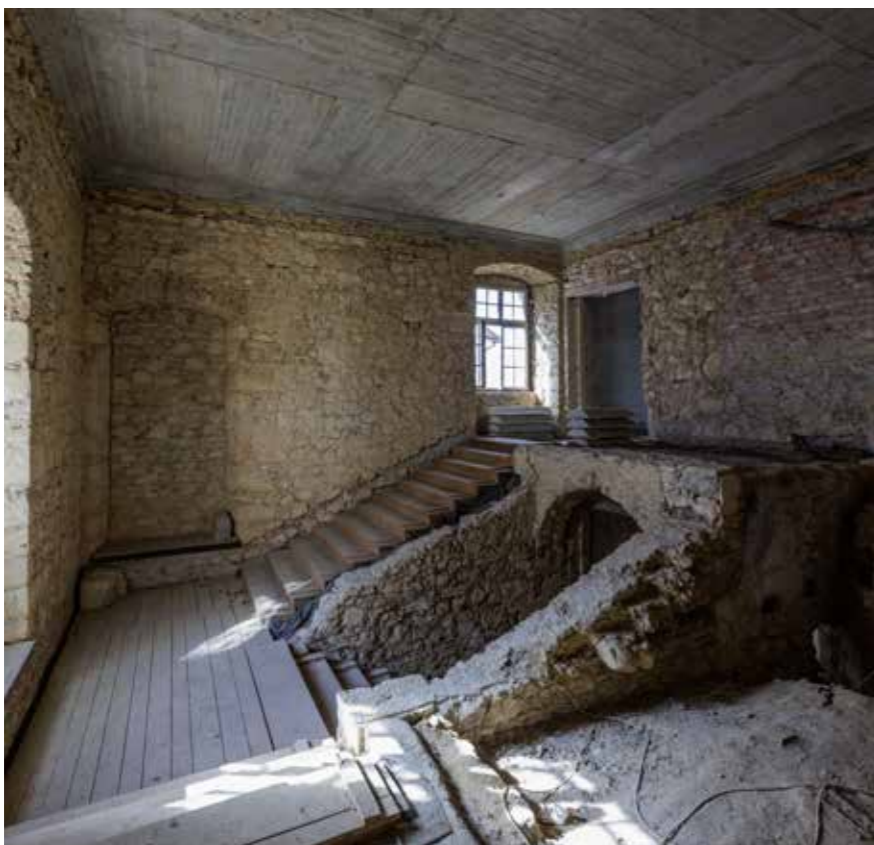
Djelomično razgrađeno trokrako stubište na drugom katu
