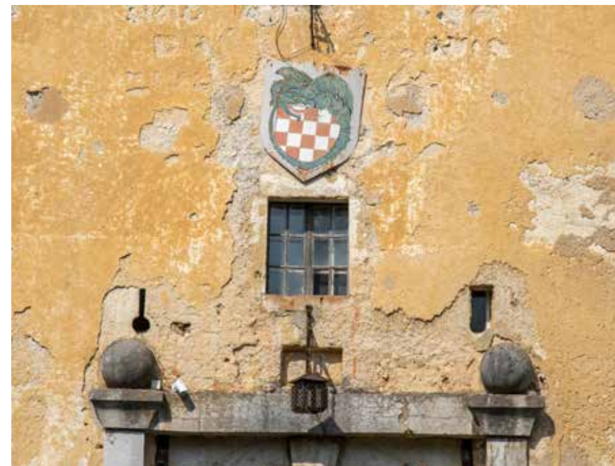
Oštećenja površine zapadnog pročelja ulazne kule i preoblikovana južna puškarnica
