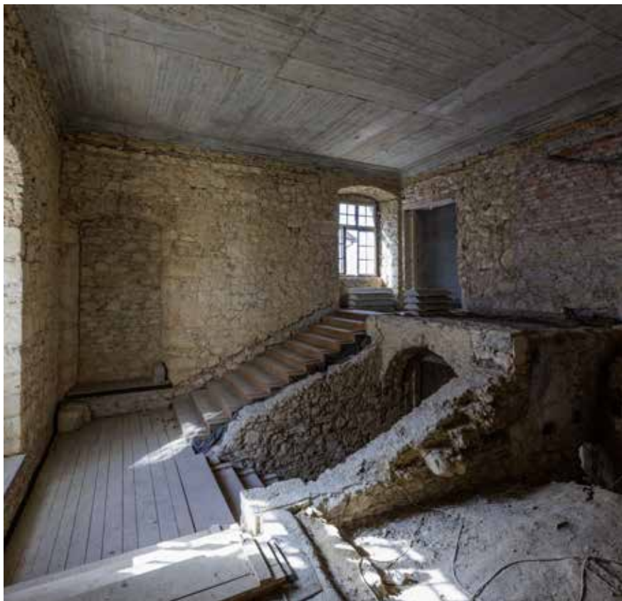
Djelomično razgrađeno trokrako stubište na drugom katu
