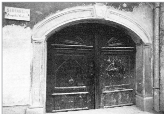
Tkalčićeva 24, kameni portal popravljen cementnom žbukom
