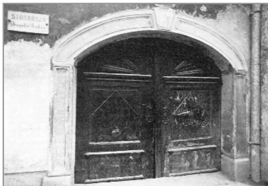
Tkalčićeva 24, kameni portal popravljen cementnom žbukom
