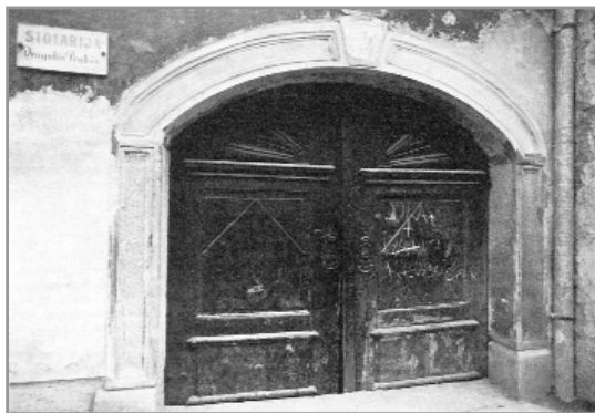
Tkalčićeva 24, kameni portal popravljen cementnom žbukom
