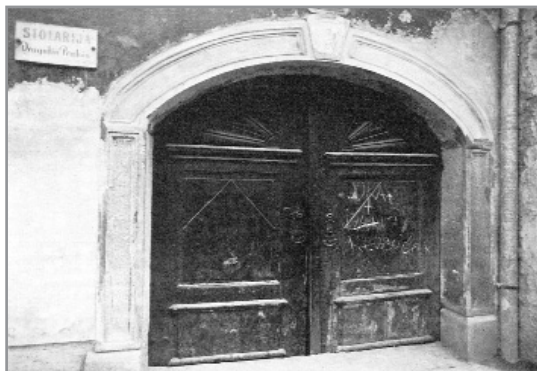
Tkalčićeva 24, kameni portal popravljen cementnom žbukom
