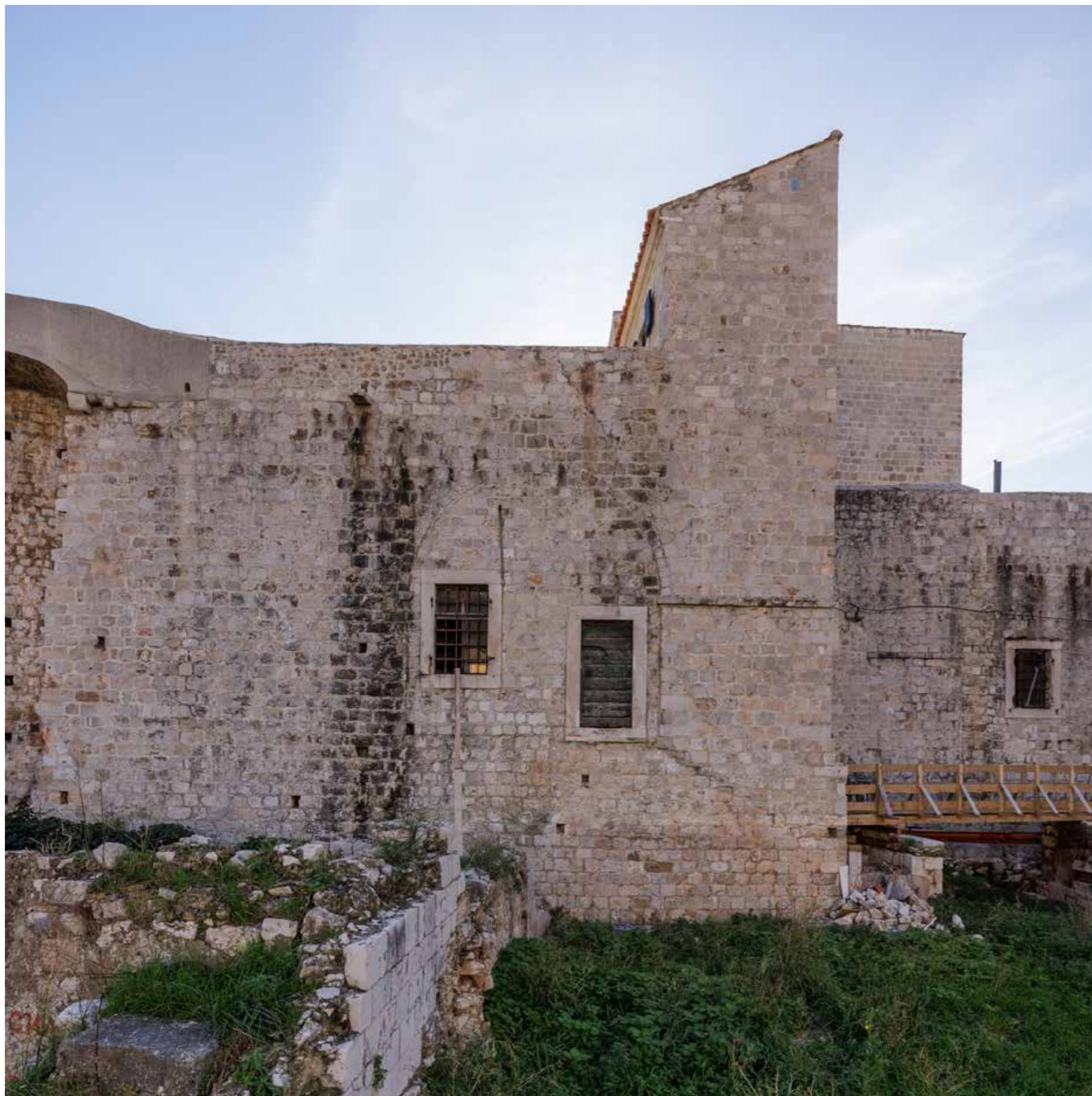
Bastion Sv. Spasitelja, sjeverno pročelje s vidljivim zazidanim lučnim otvorima i naknadnim prozorima
