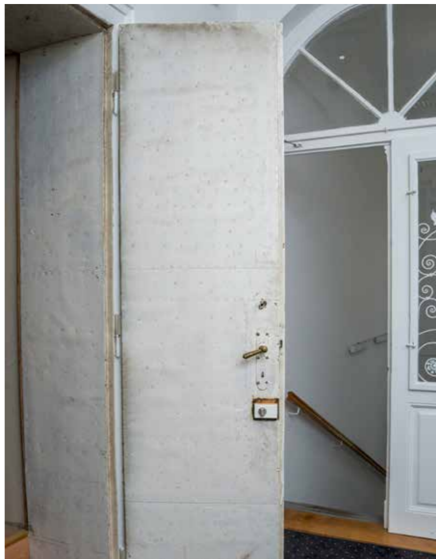
Vatrobrana vrata pema potkrovlju
