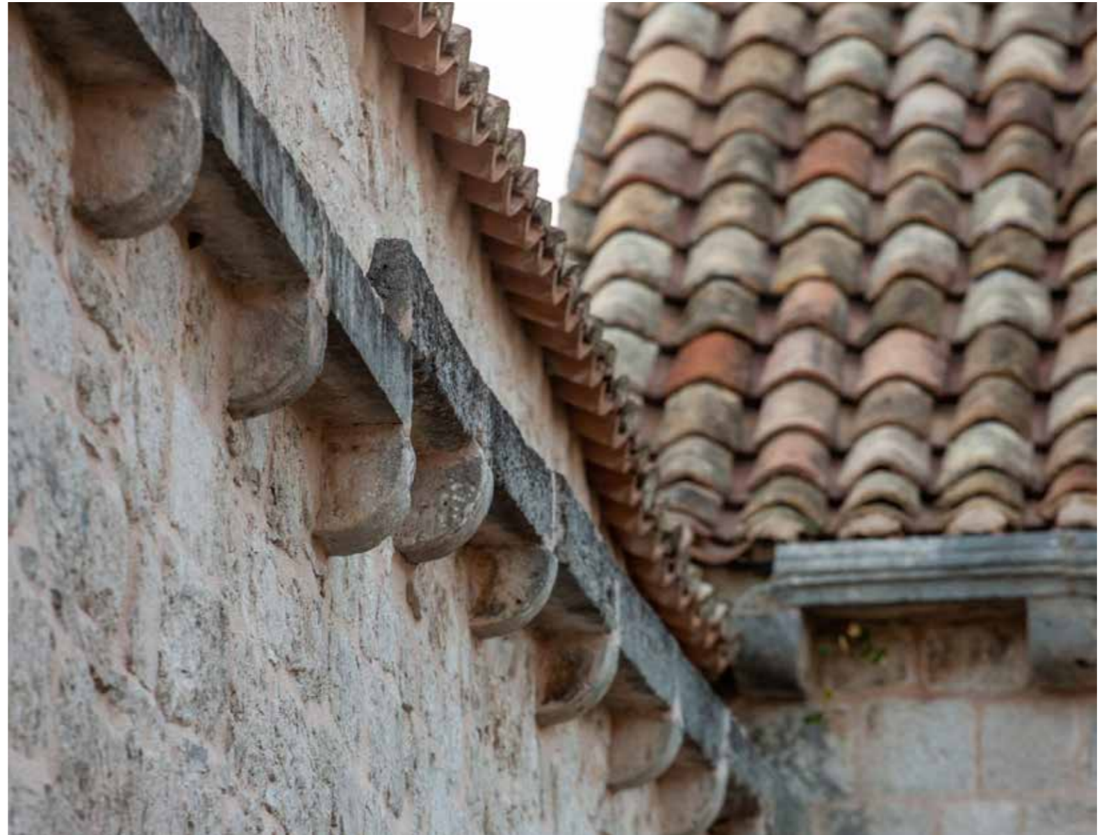
Sjeverno pročelje, žlijeb
