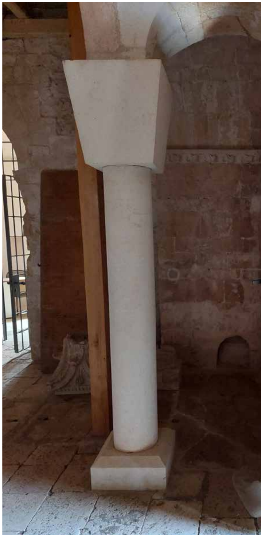
Recentni stup i kapitel koje treba zamijeniti
