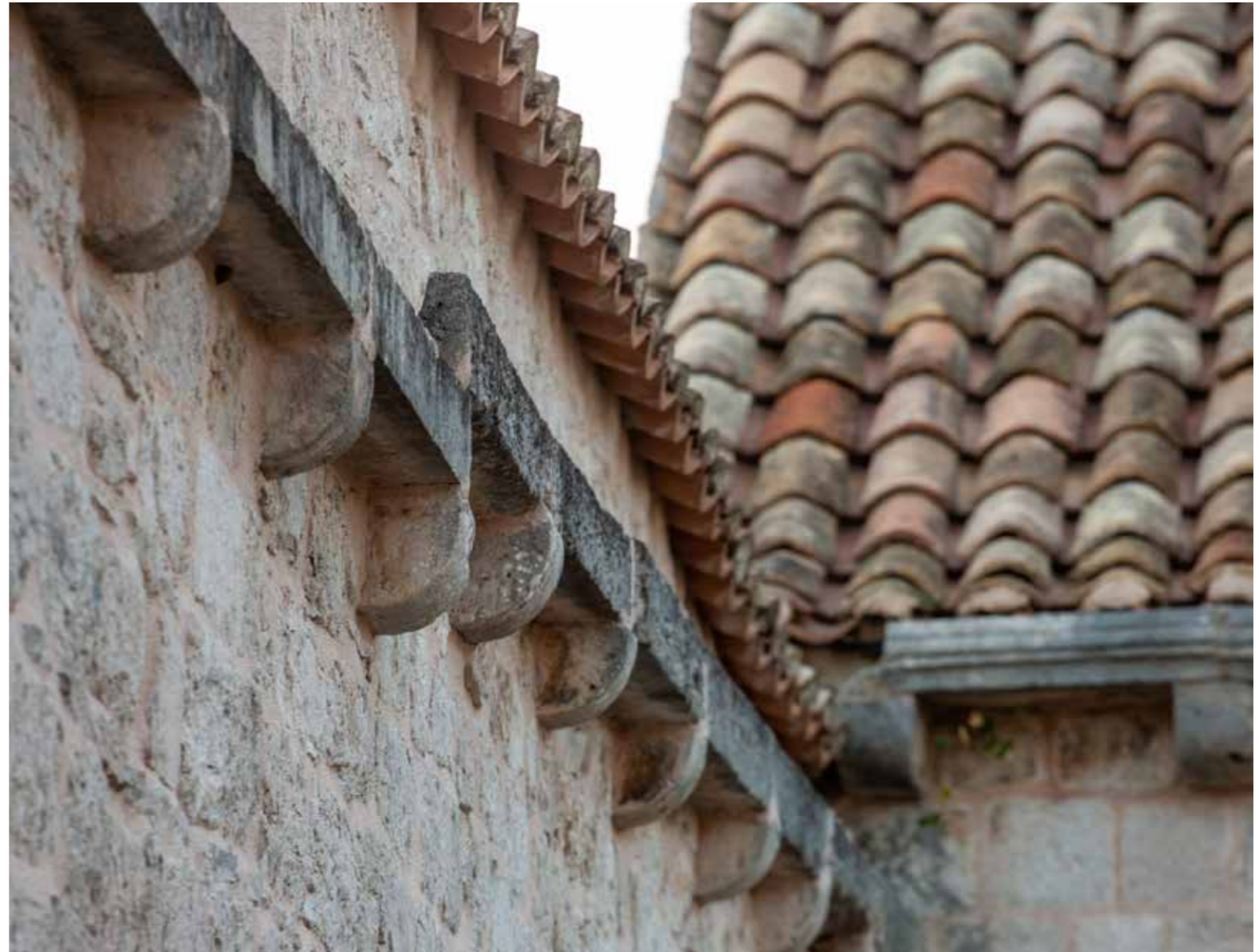
Sjeverno pročelje, žlijeb
