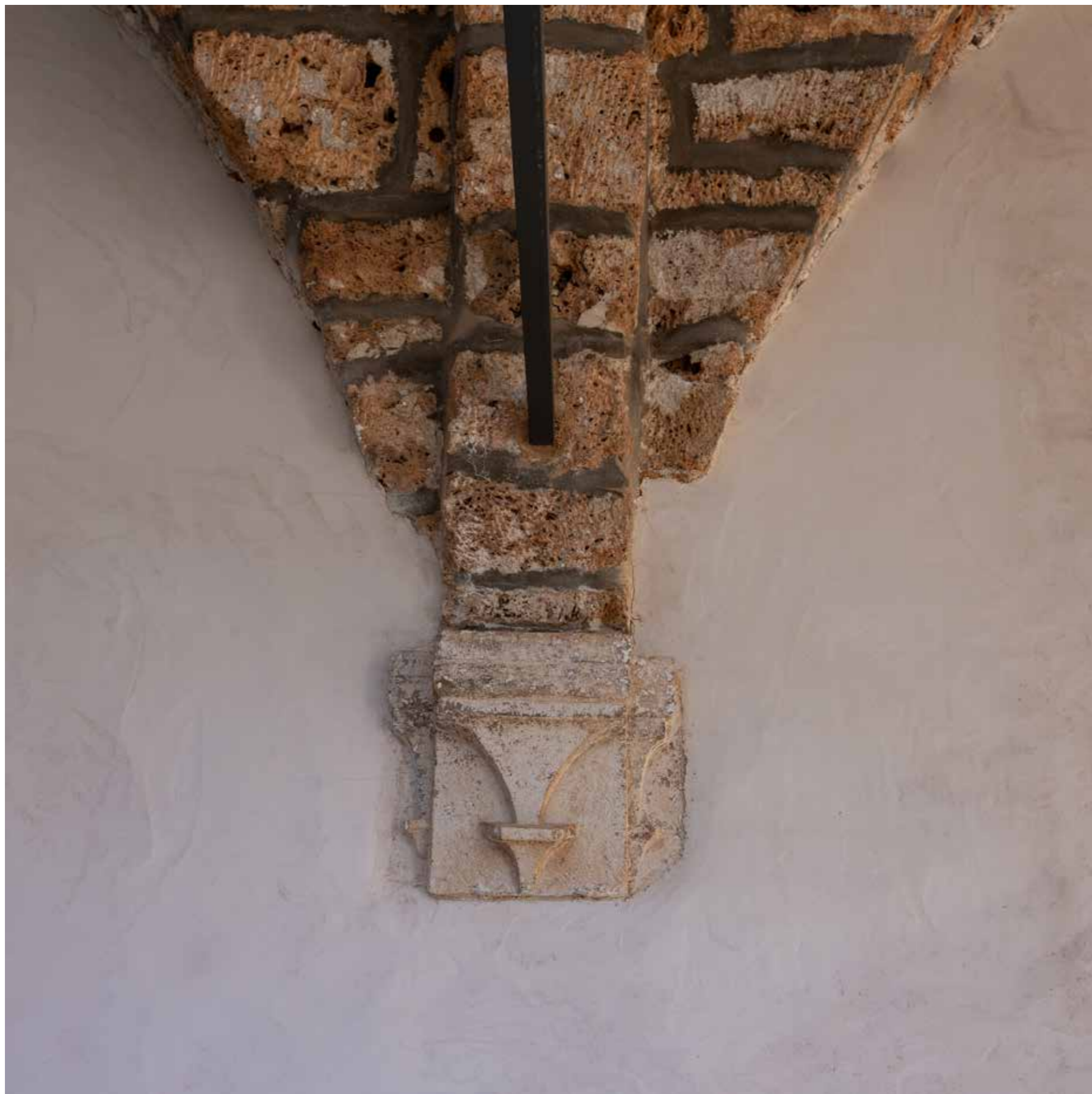
Debeo nanos cementne žbuke uz konzolu svoda u trijemu zapadnog krila i tamne cementne fuge
