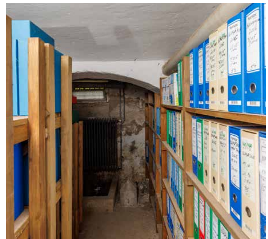
Bunjato u prizemlju, oštećenja
