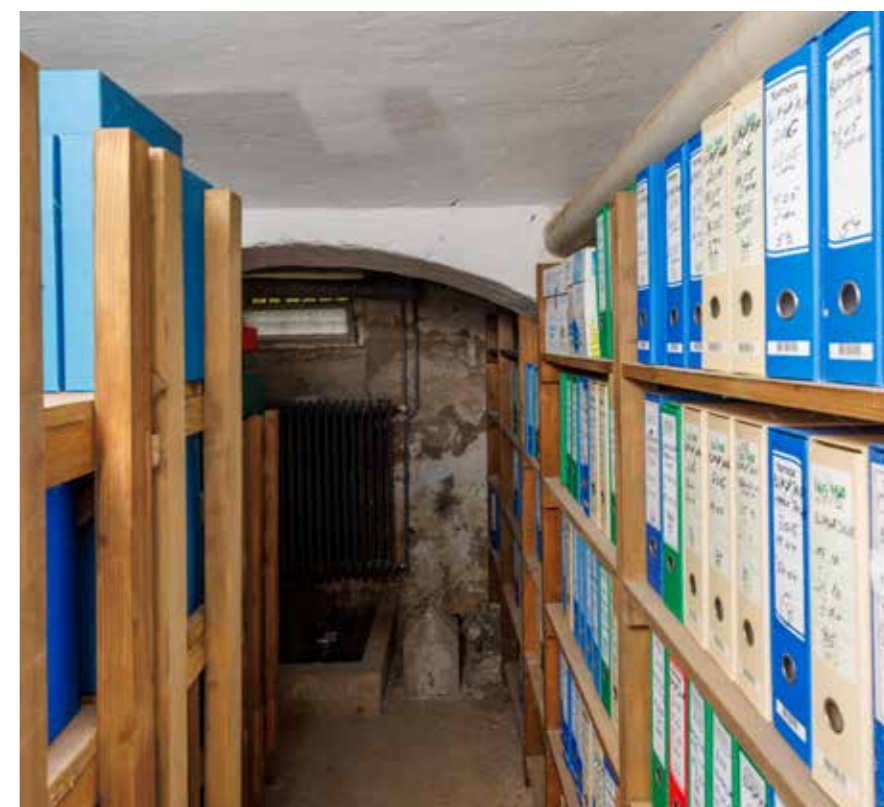
Bunjato u prizemlju, oštećenja
