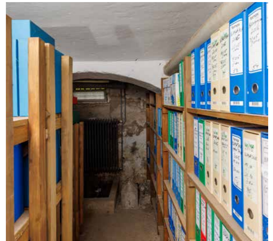
Bunjato u prizemlju, oštećenja
