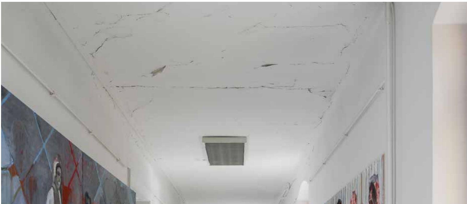
Interijer oštećen u potresima 2020.
