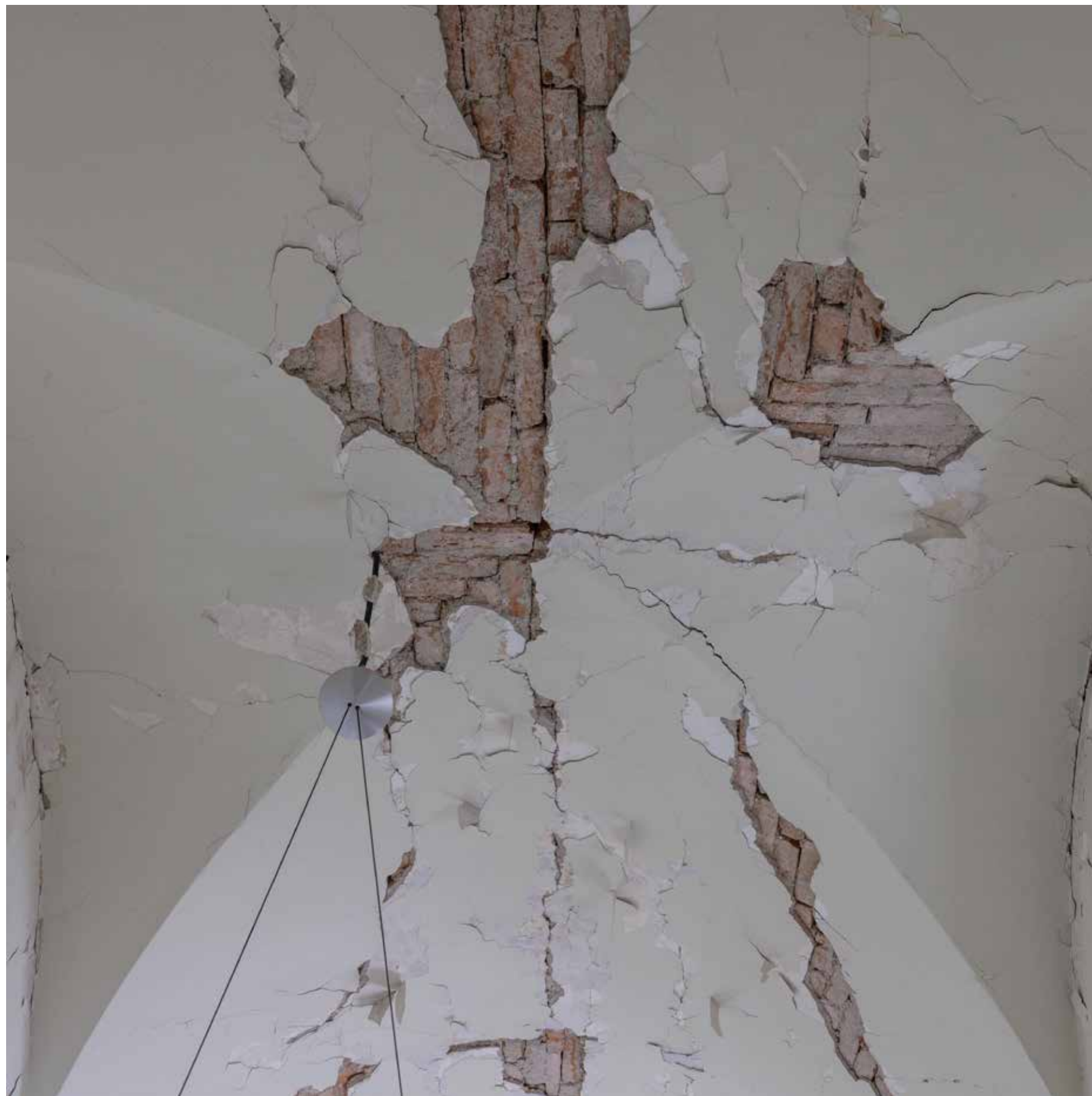
Pukotine na svodu hodnika južnog krila na drugom katu
