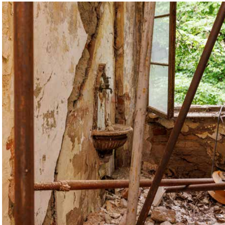
Detalji unutarnjeg prostora u ruševnom stanju
