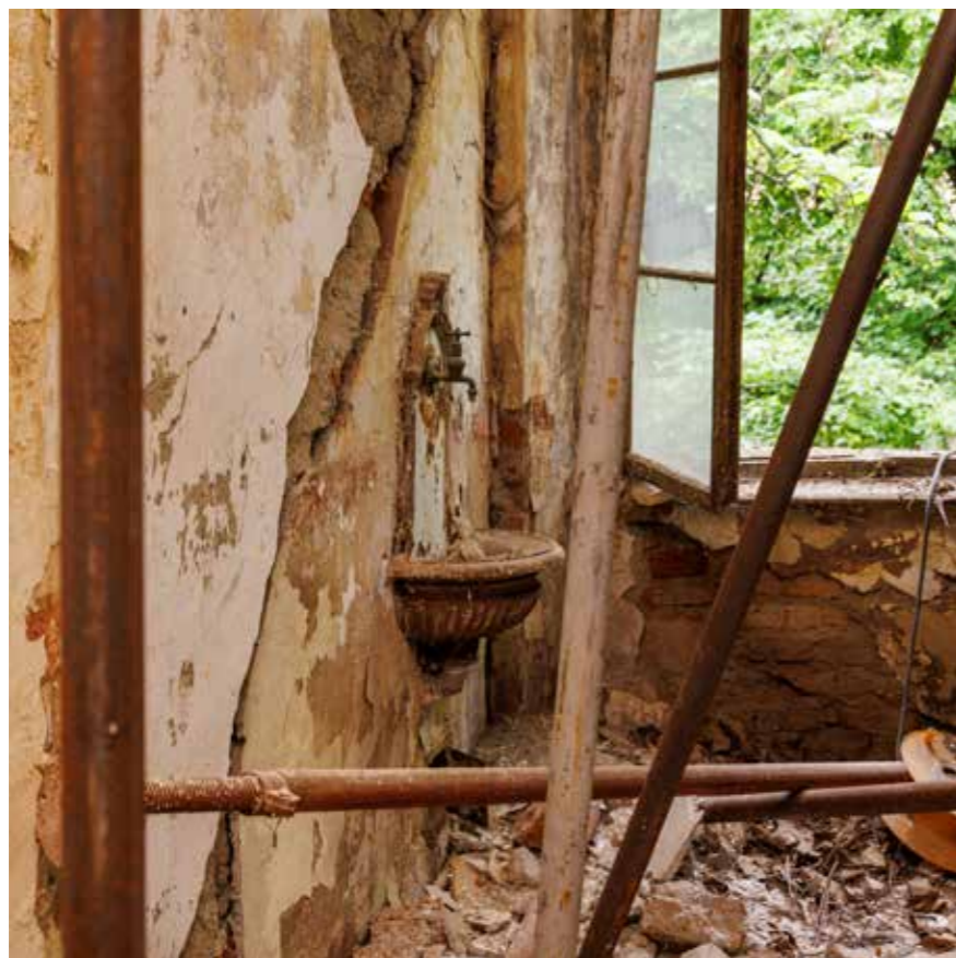
Detalji unutarnjeg prostora u ruševnom stanju
