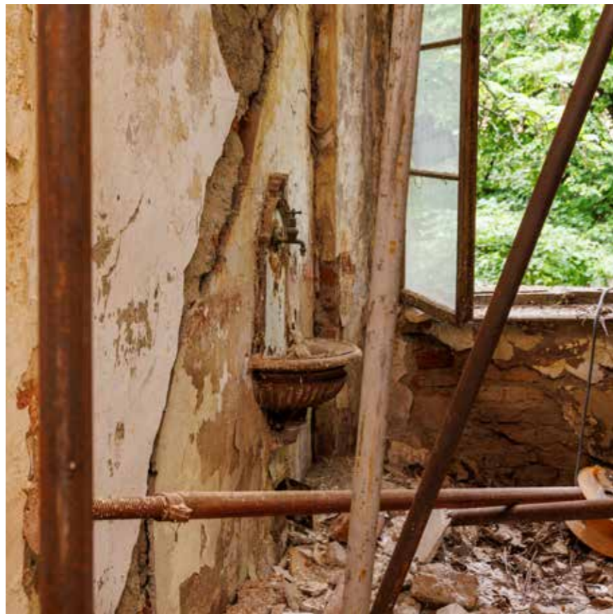
Detalji unutarnjeg prostora u ruševnom stanju
