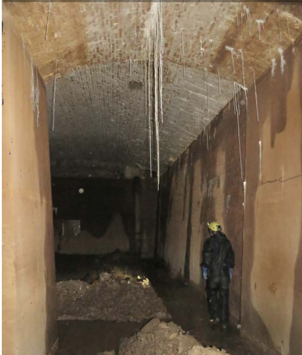
Stalaktiti koji vise iz luka i svoda u velikom spremniku, nastali ispiranjem vapnenog morta kišnicom. (foto: G. Nikšić)
