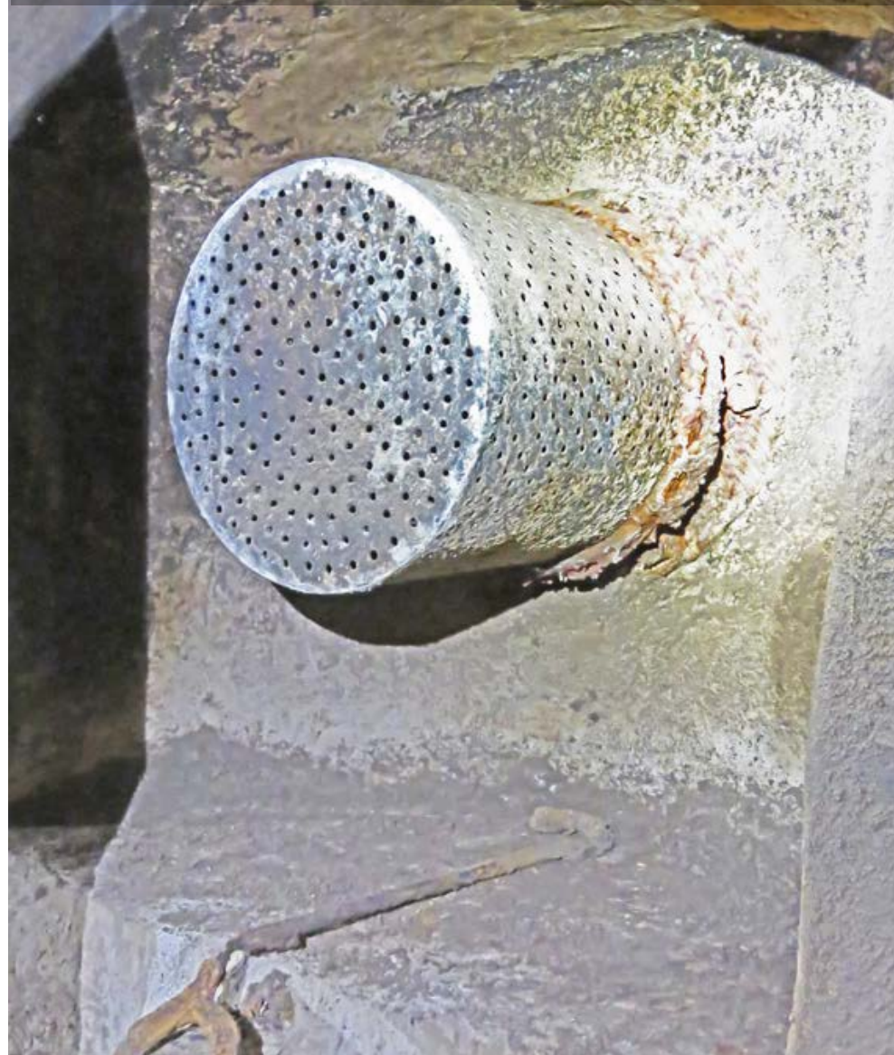
Odvodna cijev za željeznicu u velikom (sjevernom) spremniku. (foto: G. Nikšić)
