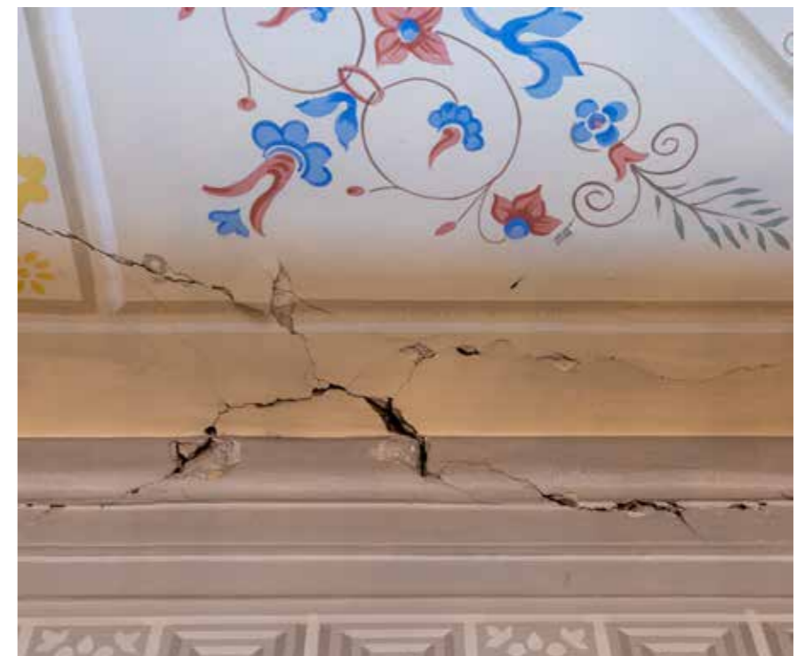
Pogled na stropnu plohu Ilirske dvorane, oštećenje zatečenog žbukanog i slikanog sloja, detalj pukotine
