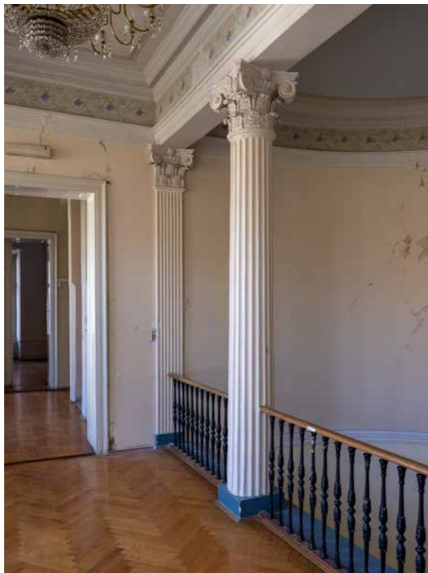
Pogled na sjeverni zid galerije stubišta, detalj izvornog oblikovanja stupova i metalne ograde
