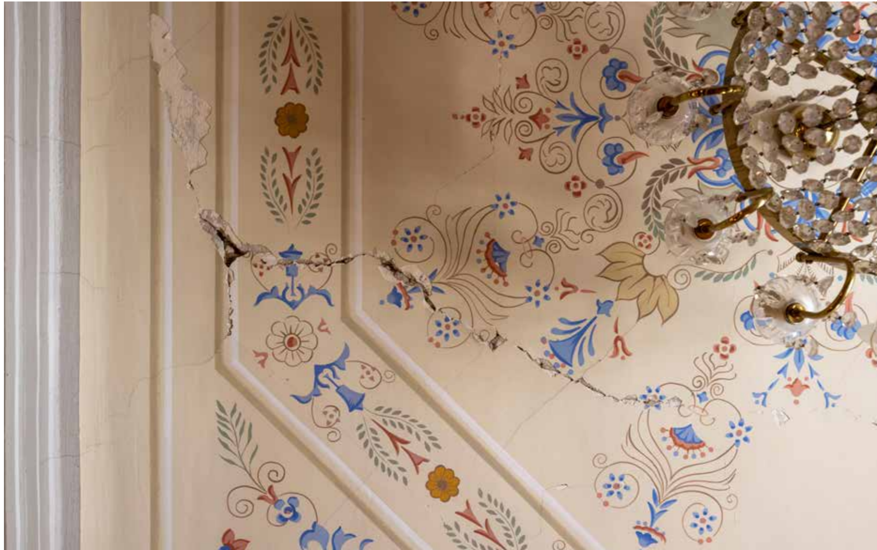
Pogled na stropnu plohu Ilirske dvorane, oštećenje zatečenog žbuknog i slikanog sloja
