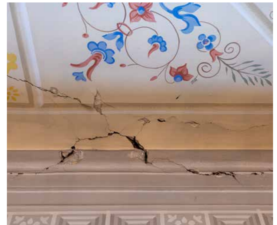
Pogled na stropnu plohu Ilirske dvorane, oštećenje zatečenog žbuknog i slikanog sloja, detalj pukotine
