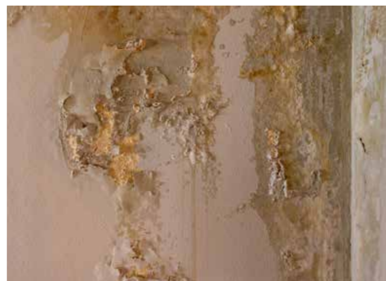
Pogled na južni zid galerije Ilirske dvorane, oštećenje zatečenog žbukanog i slikanog sloja, detalj
