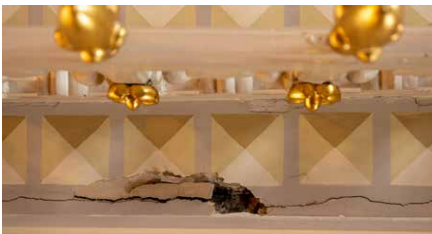
Pogled na stropnu plohu Ilirske dvorane, oštećenje zatečenog žbukanog i slikanog sloja, detalj pukotine
