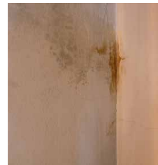
Pogled na južni zid galerije Ilirske dvorane, oštećenje zatečenog žbukanog i slikanog sloja, detalj
