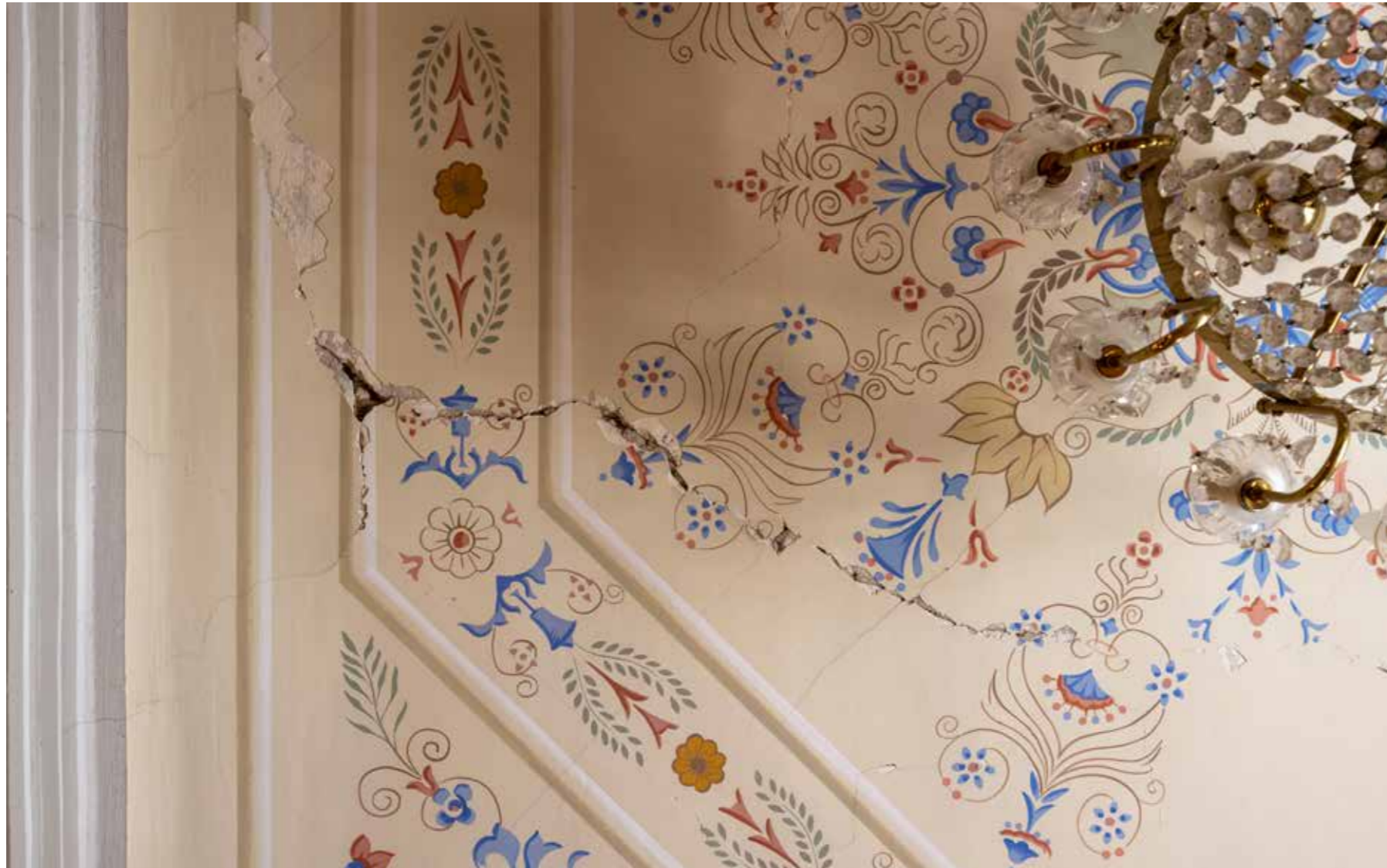
Pogled na stropnu plohu Ilirske dvorane, oštećenje zatečenog žbukanog i slikanog sloja
