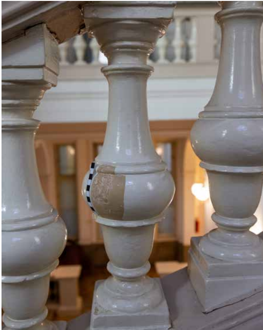
Balustrada stubišta naknadno prebojana uljanom bojom, sonda otkriva izvorni marmorizirani štuko koji treba restaurirati
