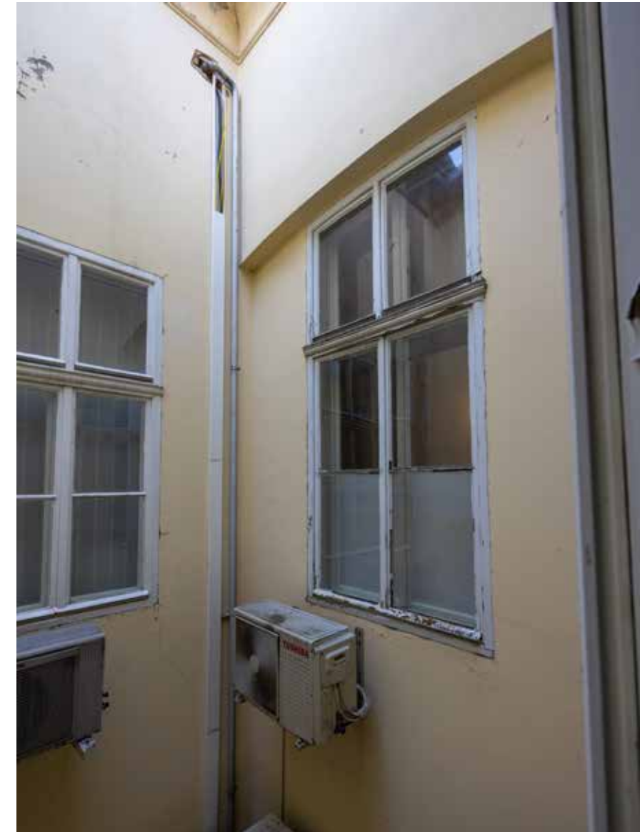
Istočni svjetlarnik, pogled na naknadno zazidanu ložu hodnika koju treba obnoviti
