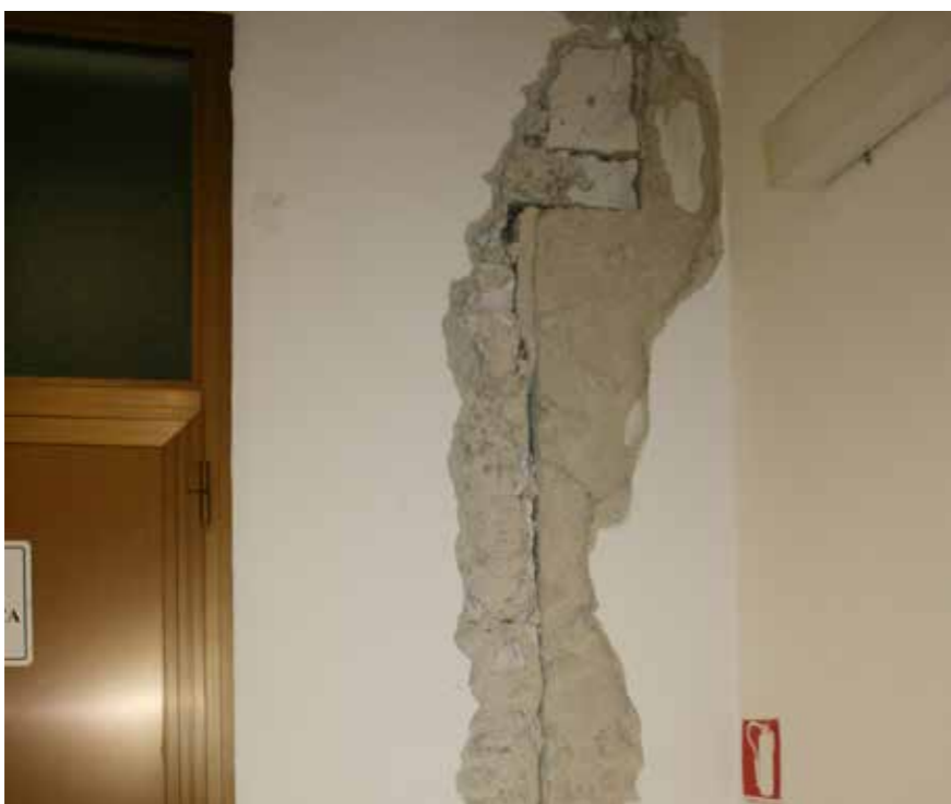
Oštećenja od potresa i neodržavanja zgrade
