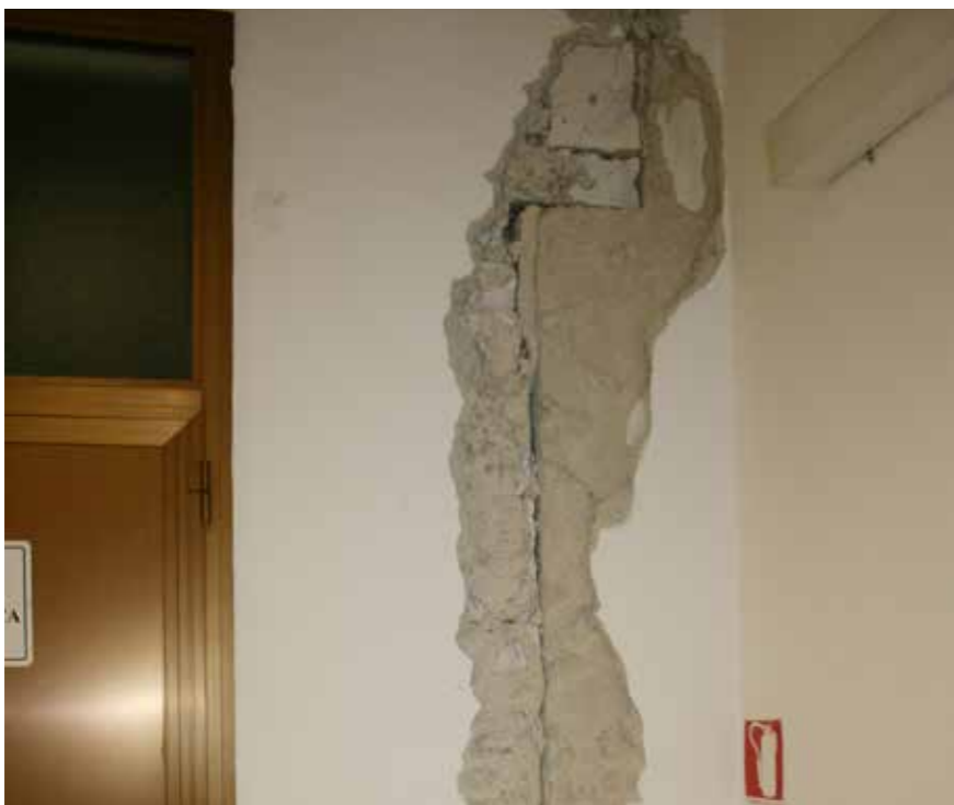
Oštećenja od potresa i neodržavanja zgrade
