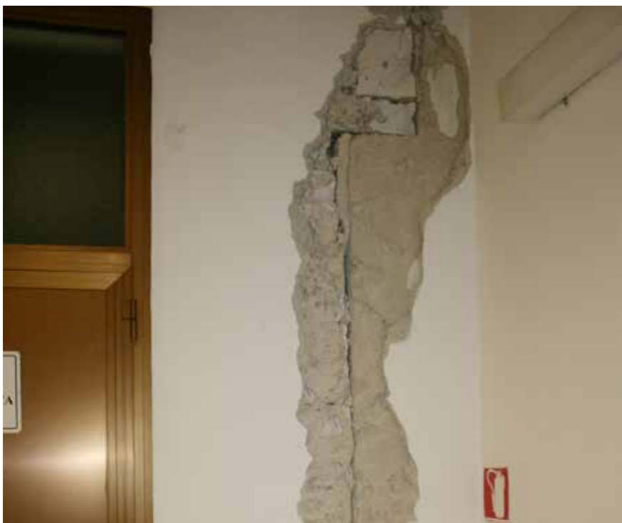
Oštećenja od potresa i neodržavanja zgrade
