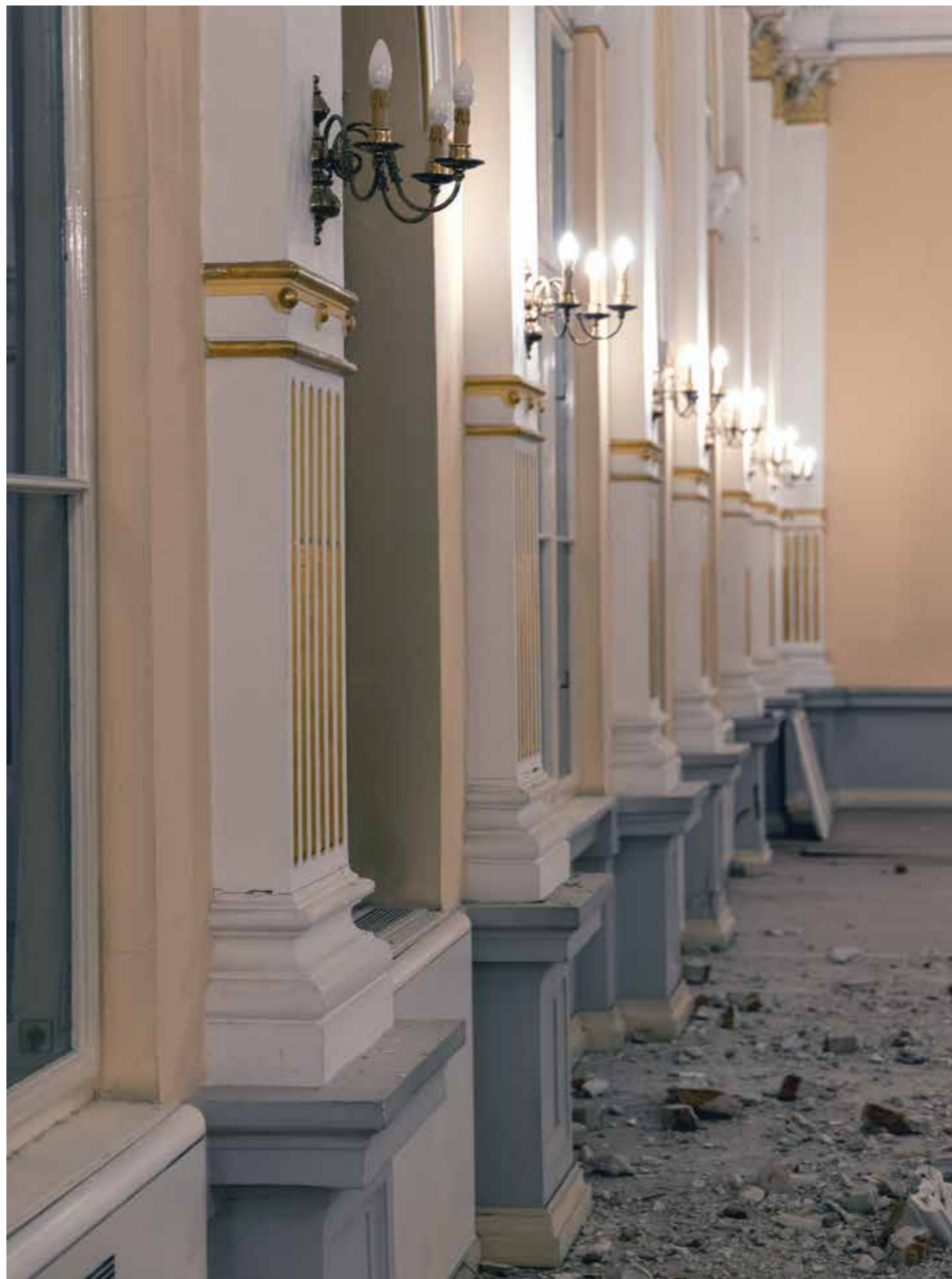
Svečana dvorana na drugom katu, oštećenja nastala u potresu 2020.
