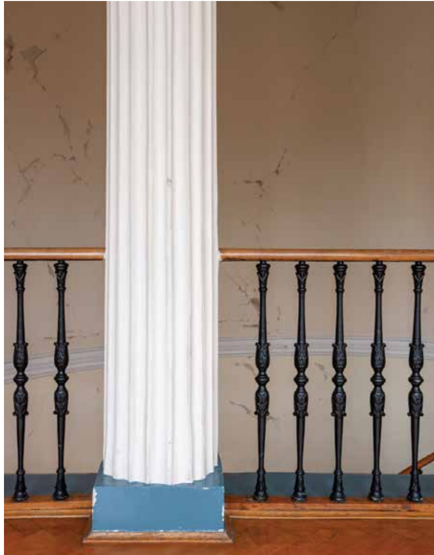
Prvi kat, prostor predvorja i stubišta, oštećenja stupa i zida
