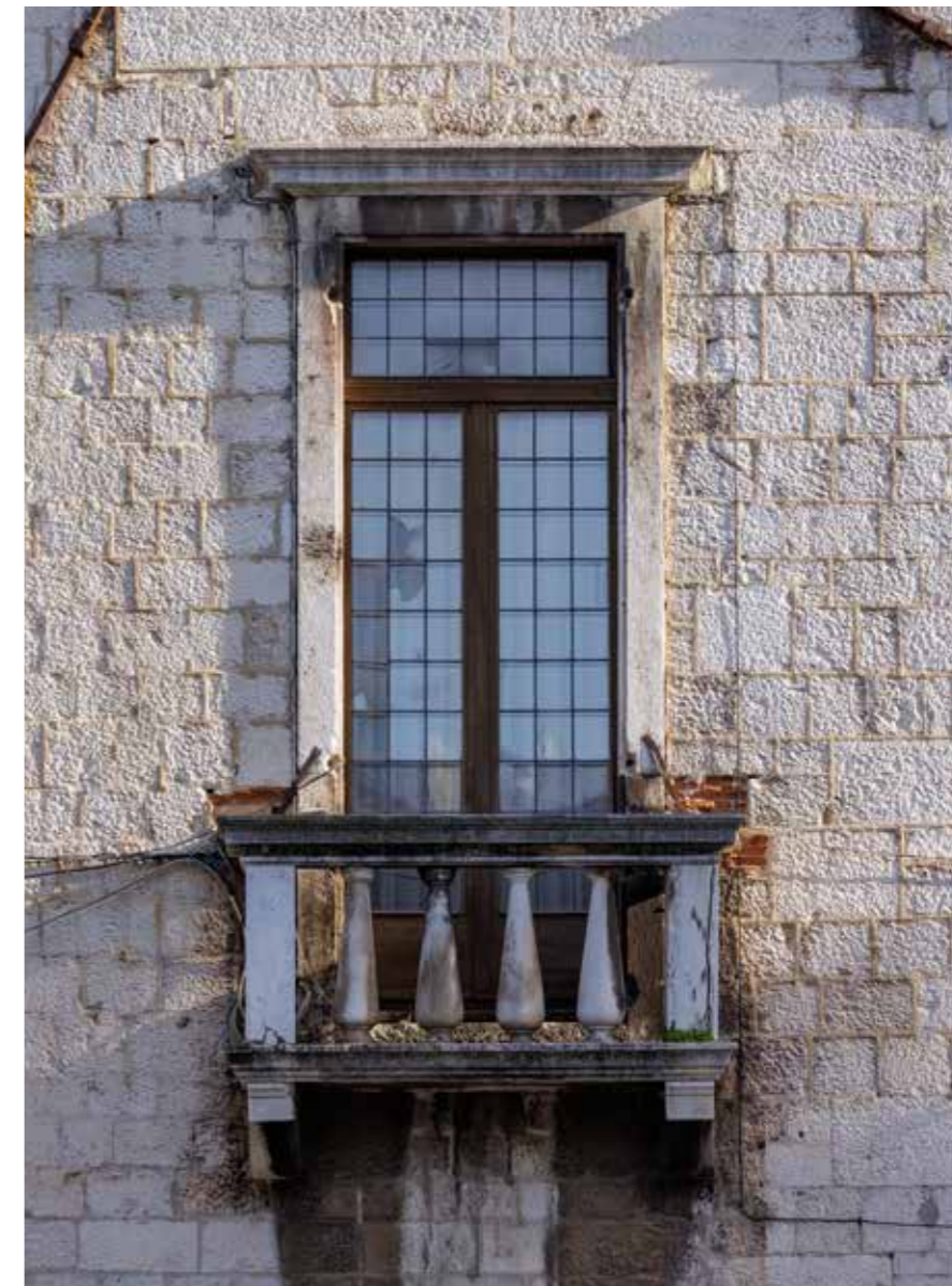
Balkon na prvom katu
