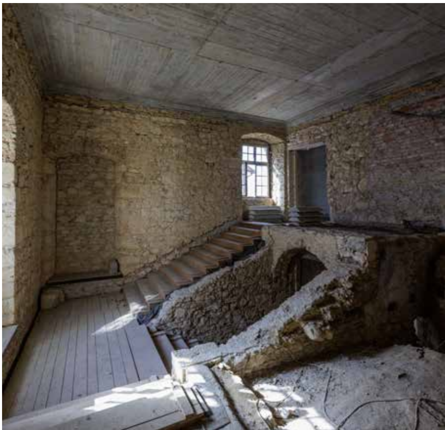
Djelomično razgrađeno trokrako stubište na drugom katu
