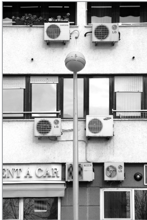
Naknadno ugrađeni klima-uređaji na pročeljima novih stambenih zgrada
