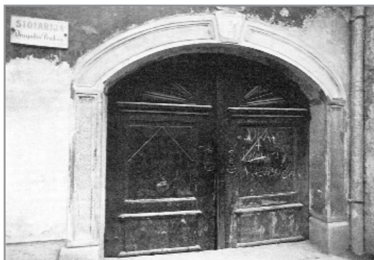
Tkalčićeva 24, kameni portal popravljen cementnom žbukom
