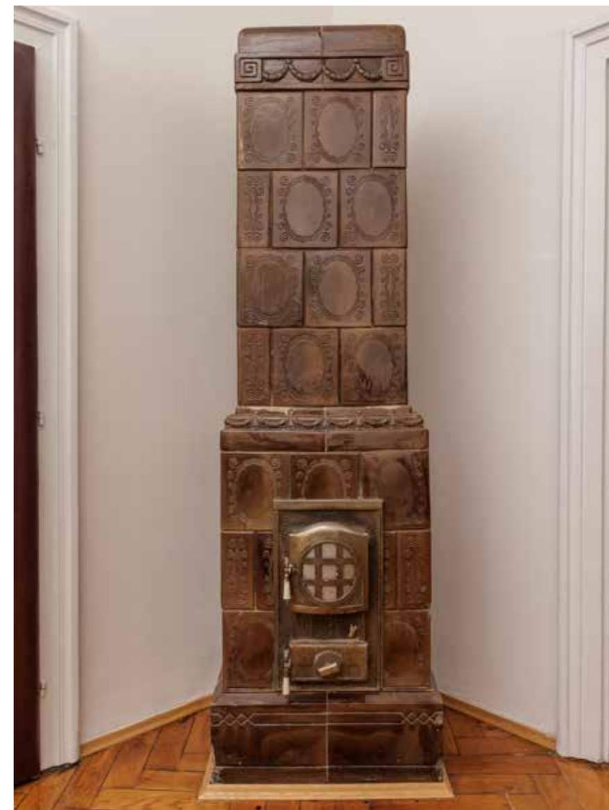
Kaljeva peč na prvom katu
