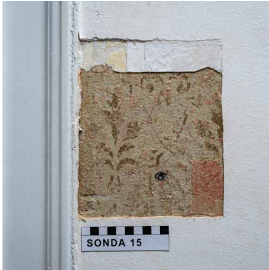
Oslik u nekadašnjem stanu ravnatelja otkriven restauratorskim sondiranjem
