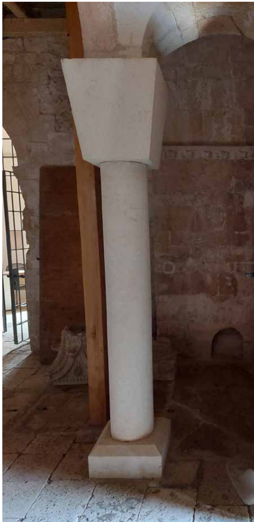
Recentni stup i kapitel koje treba zamijeniti
