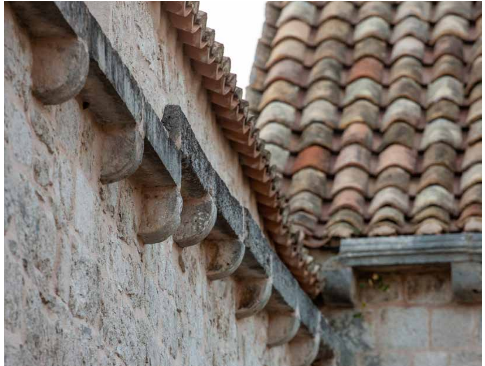
Sjeverno pročelje, žlijeb
