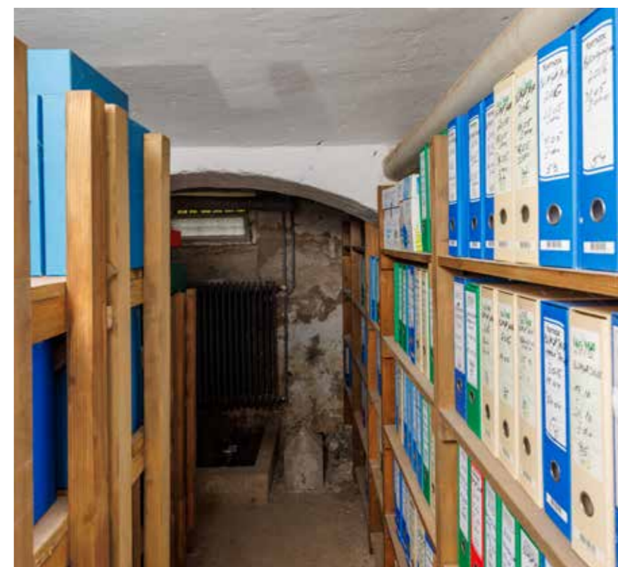
Bunjato u prizemlju, oštećenja
