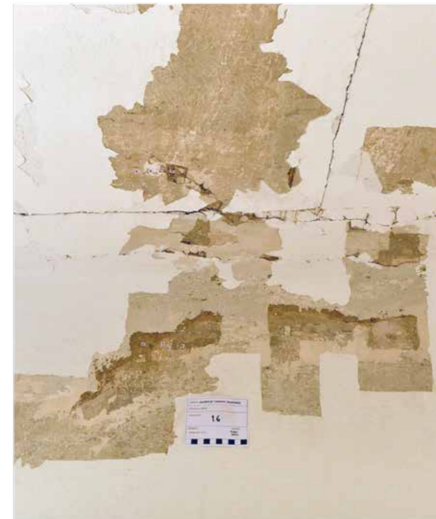
Foto br.5 spoj zida i stropa, hodnik, I kat - zapad, sonda broj 16.
