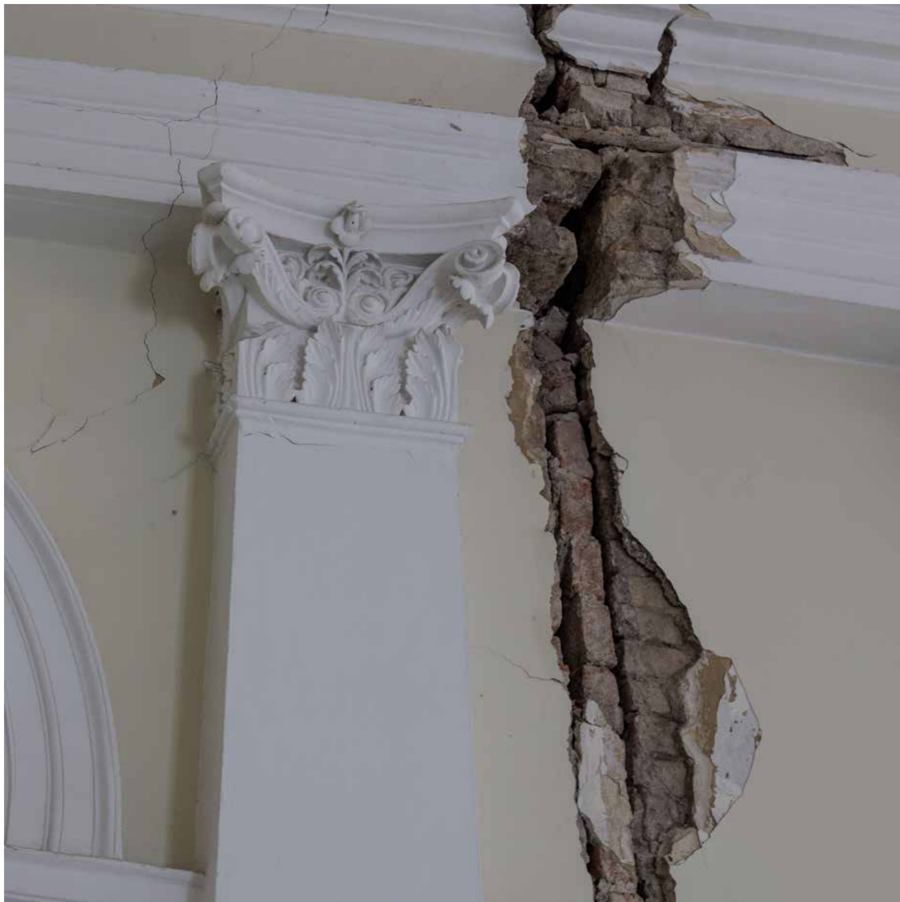
Pukotina na spoju zgrade i prigradenoga glavnog stubišta
