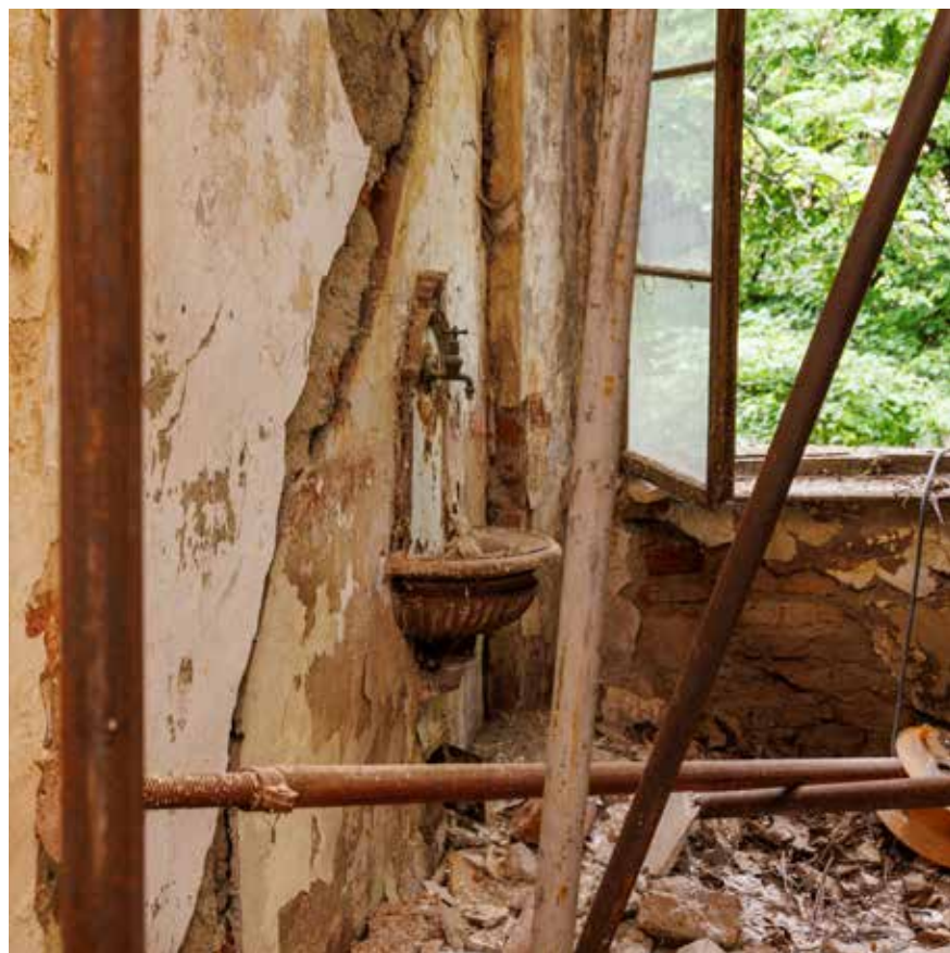
Detalji unutarnjeg prostora u ruševnom stanju
