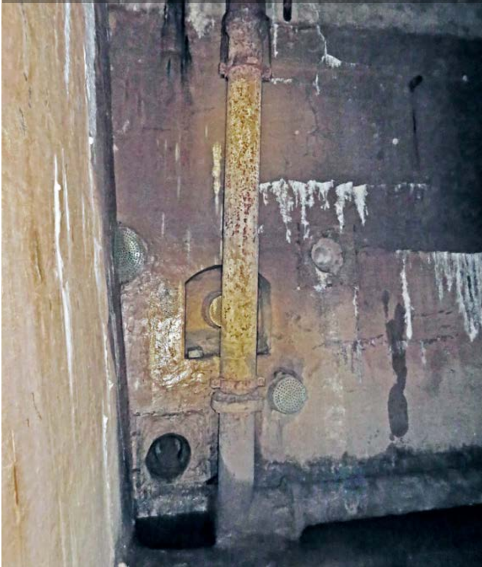
Veliki (sjeverni) spremnik s odvodnim cijevima i preljevnom cijevi. (foto: G. Nikšić)
