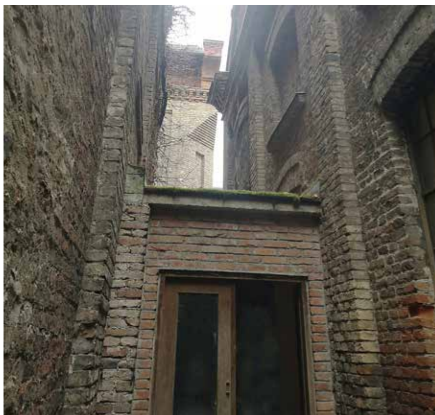
Istočna dvorišna zgrada, pogled na sjeverno pročelje i koridor koji spaja istočnu i sjevernu zgradu
