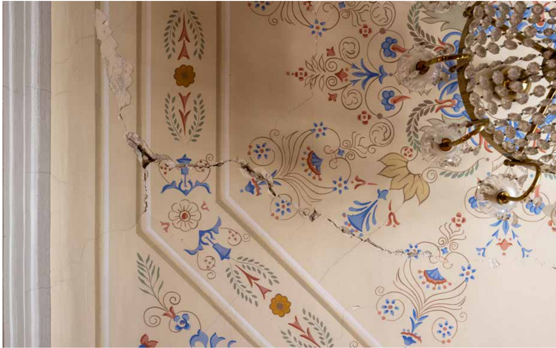
Pogled na stropnu plohu Ilirske dvorane, oštećenje zatečenog žbuknog i slikanog sloja
