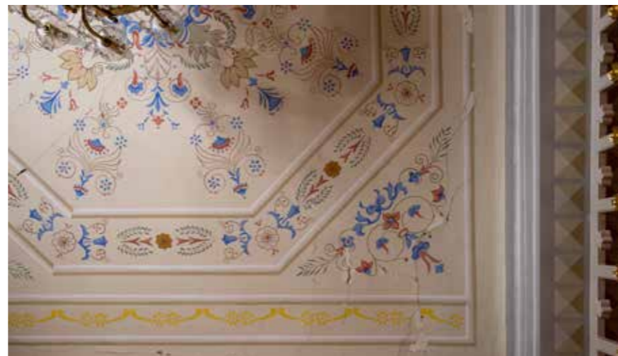
Pogled na stropnu plohu Ilirske dvorane, oštećenje slikanog sloja
