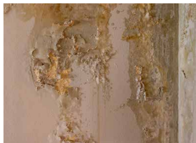
Pogled na južni zid galerije Ilirske dvorane, oštećenje zatečenog žbukanog i slikanog sloja, detalj
