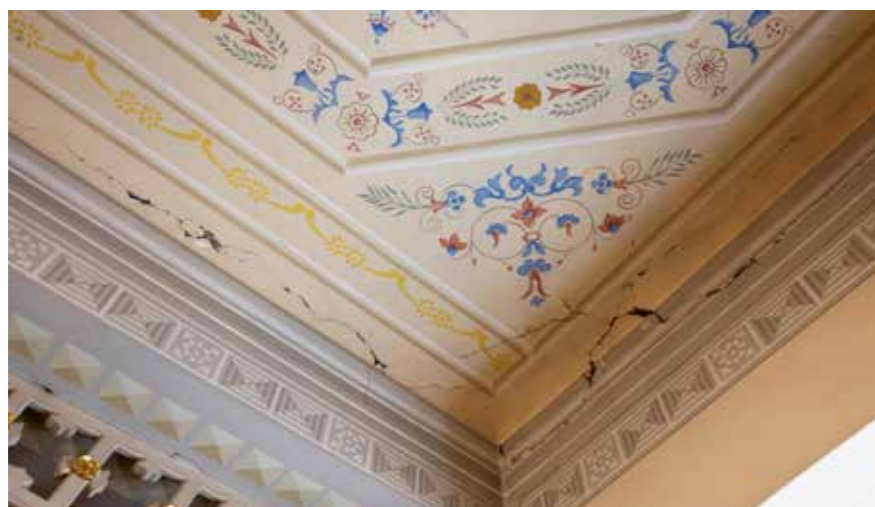
Pogled na stropnu plohu Ilirske dvorane, oštećenje zatečenog žbuknog i slikanog sloja
