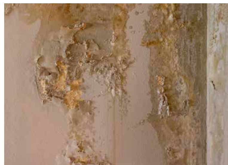
Pogled na južni zid galerije Ilirske dvorane, oštećenje zatečenog žbuknog i slikanog sloja, detalj
