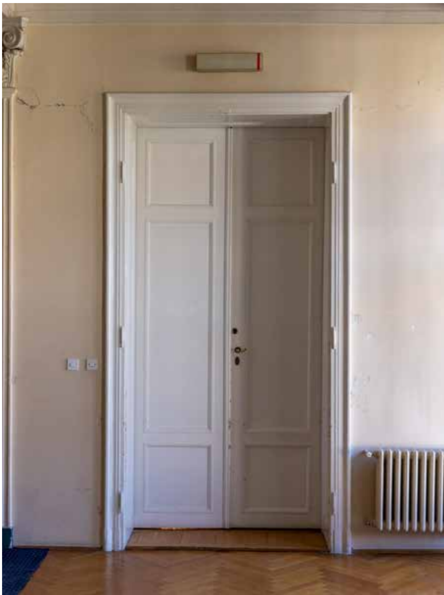
Vrata južnog zida galerije stubišta, detalj nedostajućih vratnica
