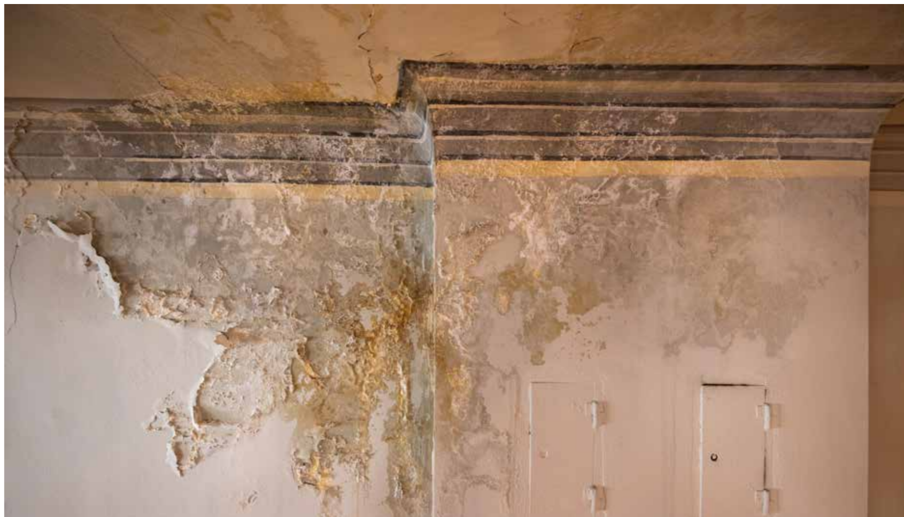
Pogled na južni zid galerije Ilirske dvorane, oštećenje zatečenog žbukanog i slikanog sloja
