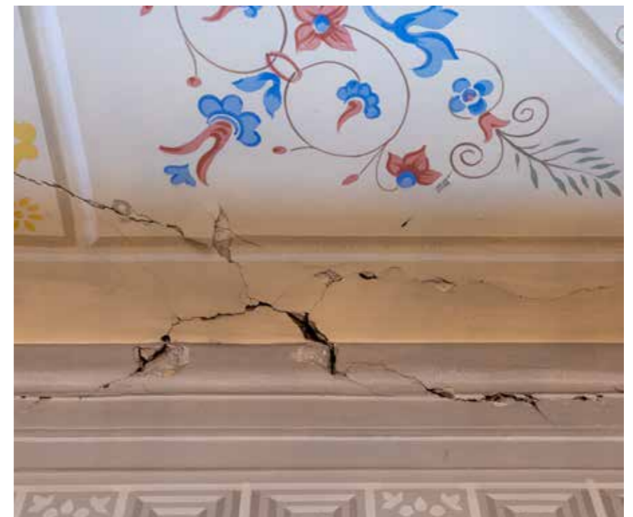
Pogled na stropnu plohu Ilirske dvorane, oštećenje zatečenog žbuknog i slikanog sloja, detalj pukotine
