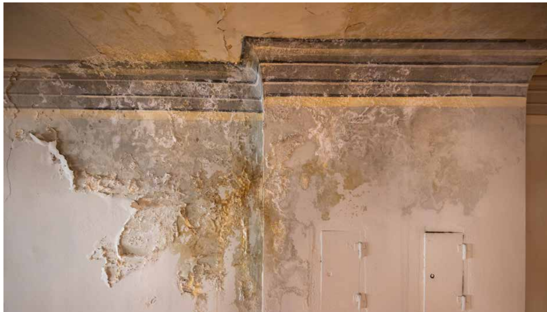
Pogled na južni zid galerije Ilirske dvorane, oštećenje zatečenog žbukanog i slikanog sloja
