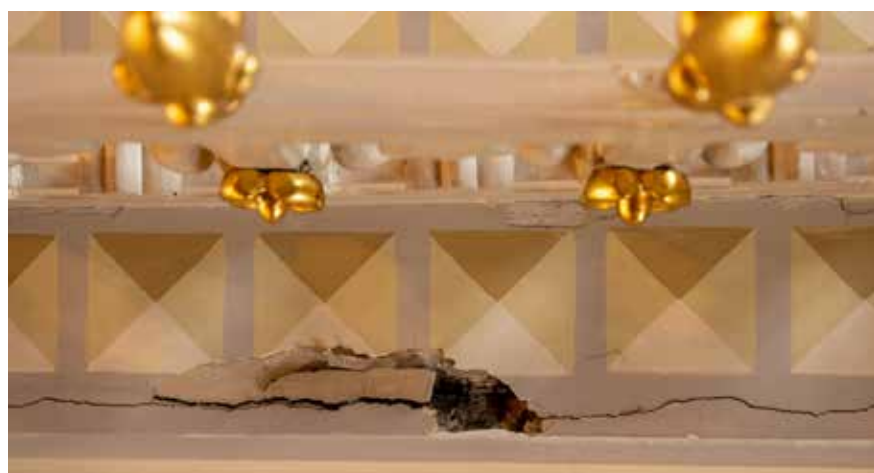
Pogled na stropnu plohu Ilirske dvorane, oštećenje zatečenog žbuknog i slikanog sloja, detalj pukotine
