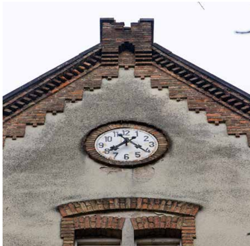
Zabat dvorišnog rizalita s oštećenim elementima raščlambe i dekoracije
