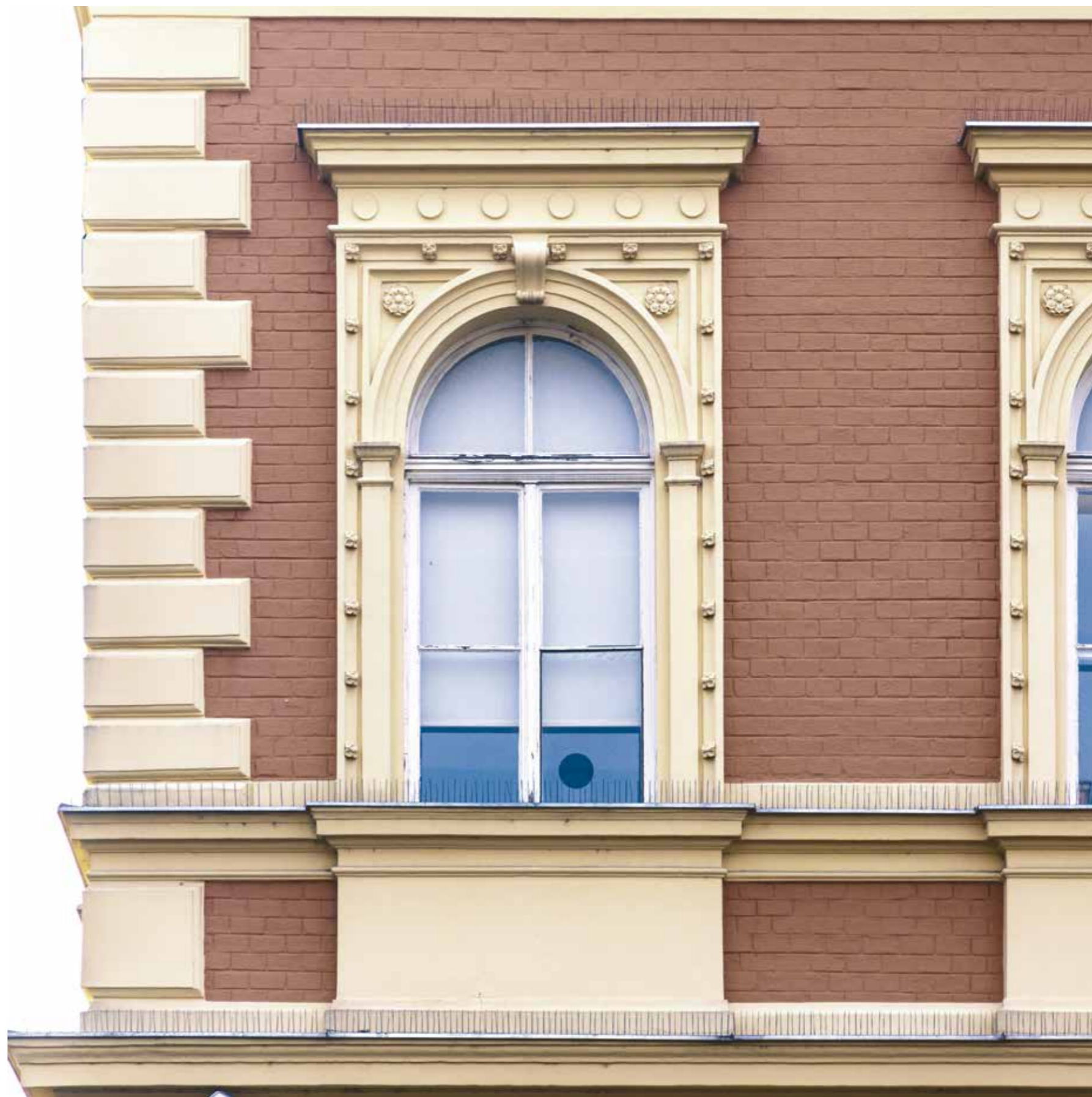
Pročelje, detalj s prozorom na prvom katu i fasadnom opekom koju treba restaurirati
