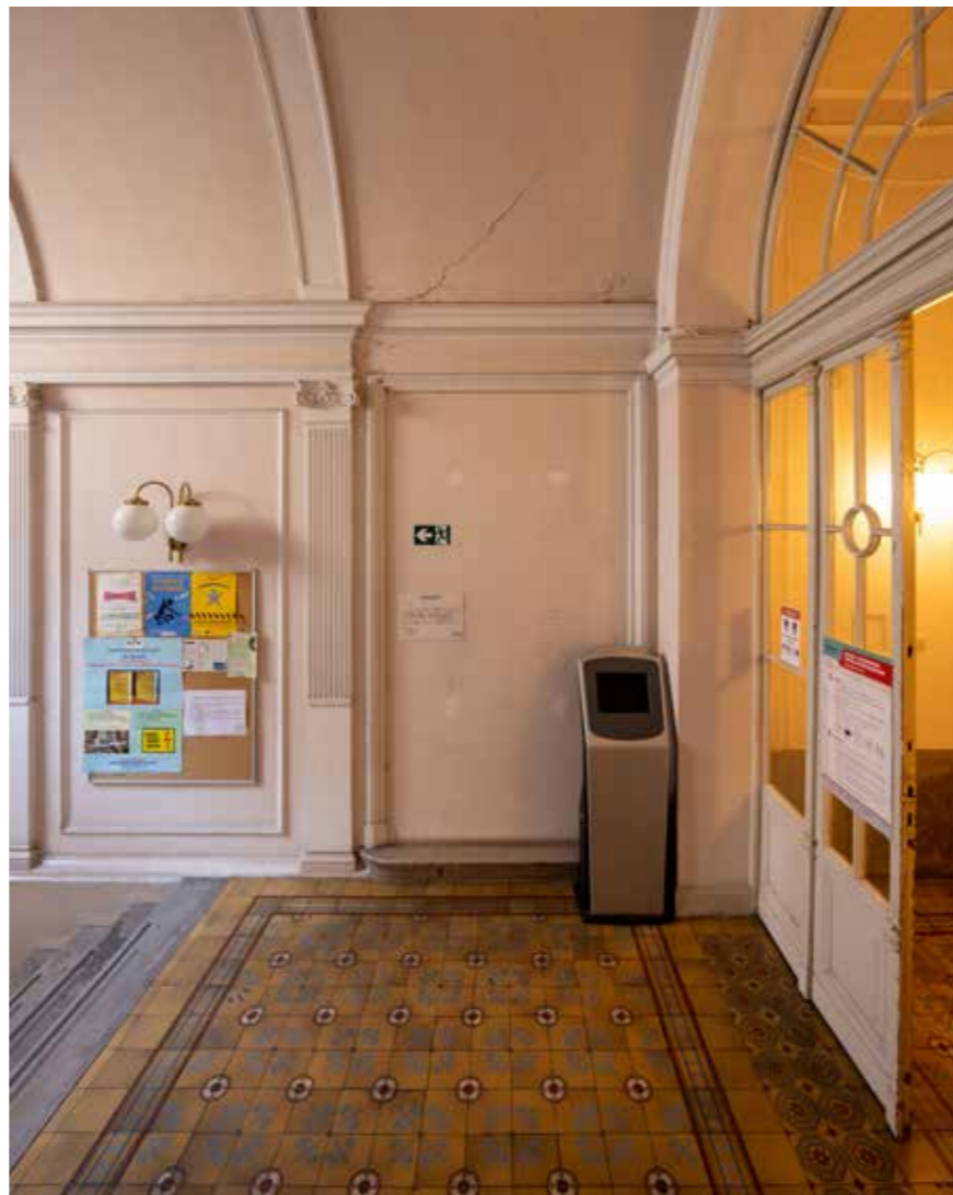
Predvorje, zazidani ulaz u srednji dio prizemlja koji treba rekonstruirati
