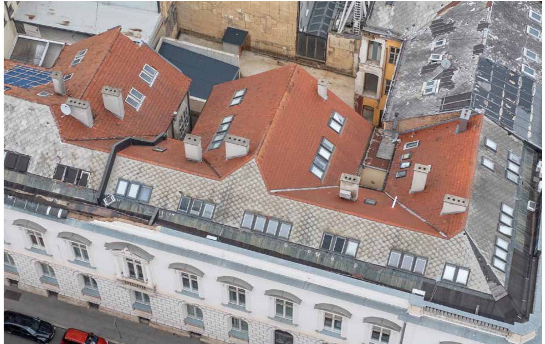
Pogled na krovnište, pokrov sivim eternitom treba ponoviti u novom materijalu (vlaknocementne bezazbestne ploče) uz istovjetni format i način slaganja
