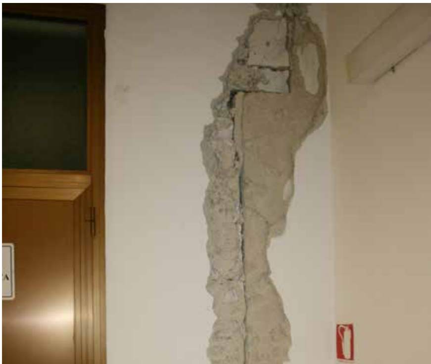
Oštećenja od potresa i neodržavanja zgrade
