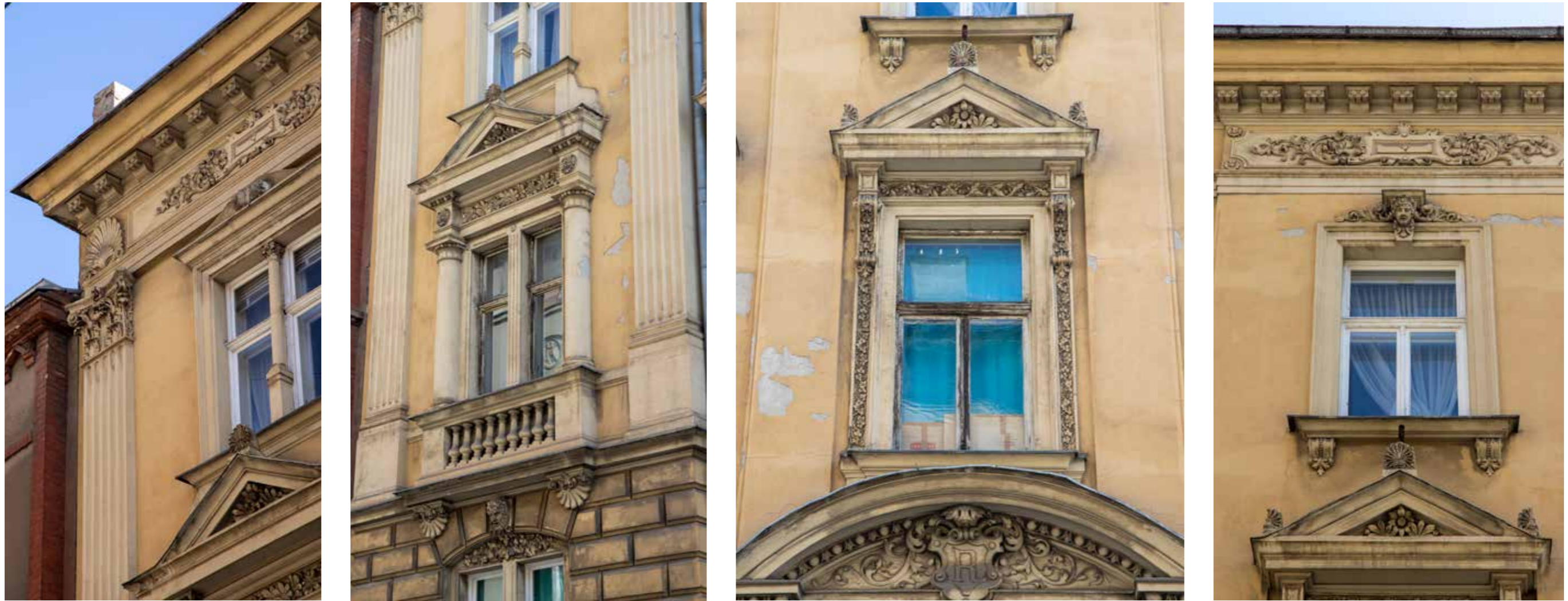
Dvojni prozori na rizalitu • Prozor na prvom katu • Prozor na drugom katu
