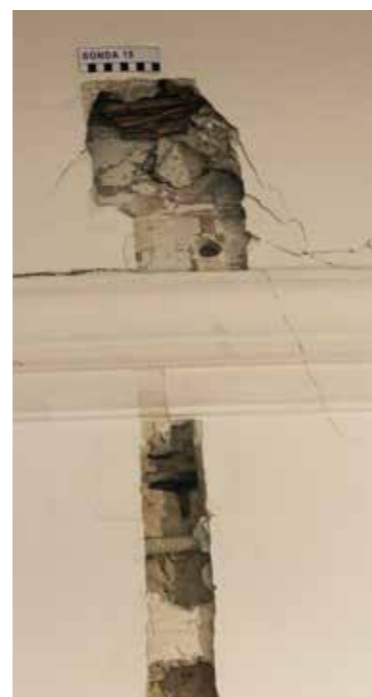
Sonda 15 iznad vrata na južnom zidu sjeverozapadnog salona u prizemlju s tragovima dekorativnih naliča koji pokazuju drukčije oblikovanje svoda prostorije
