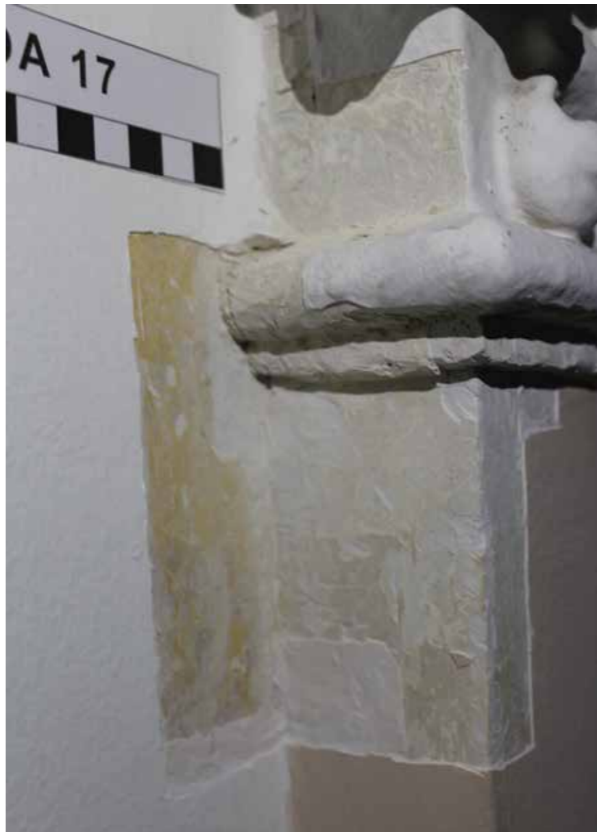
Sonde 17 i 18 u stubištu s nalazom izvorne marmorizacije
