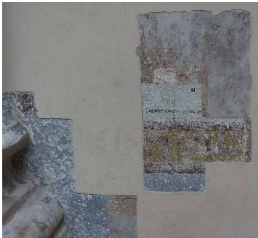
Sonda 23 u galeriji na drugom katu atrija (zapadni zid) s dvjema vidljivim fazama neorenesansnog oslika
