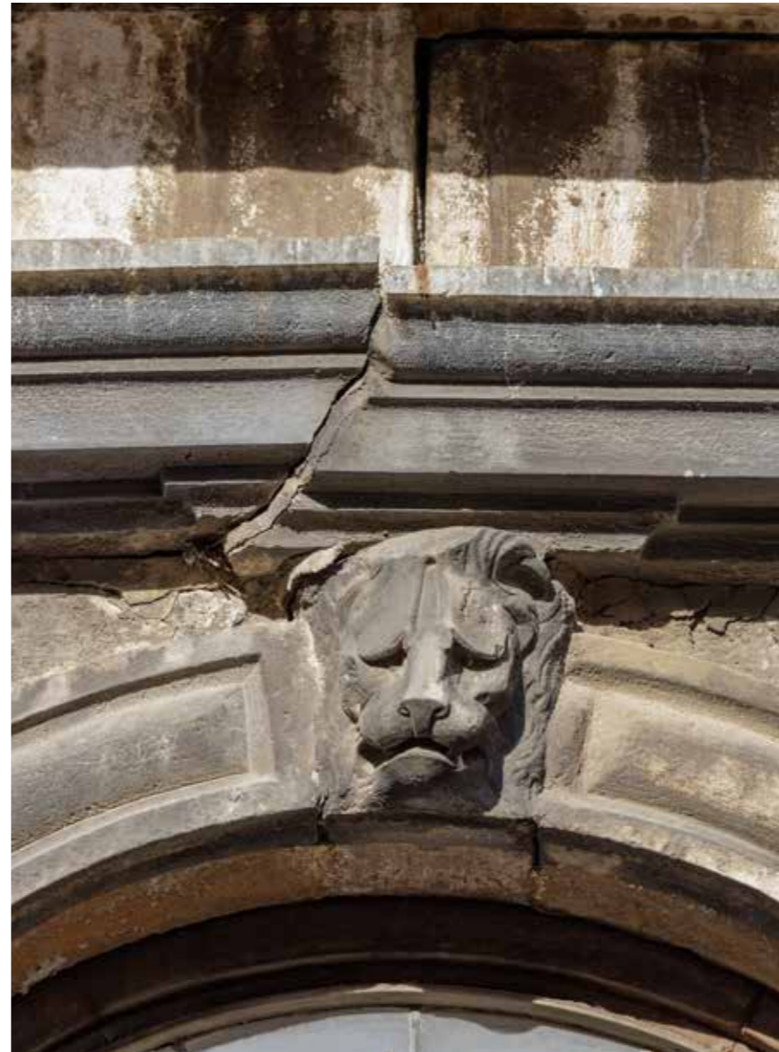
Francuski prozor na južnom pročelju, detalj s oštećenjima
