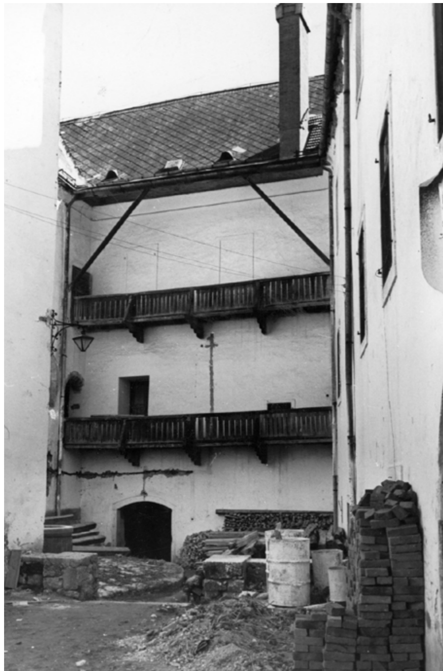
Istočno dvorište s ganjkom na prvom i drugom katu, naknadno uklonjenim (MKM)
