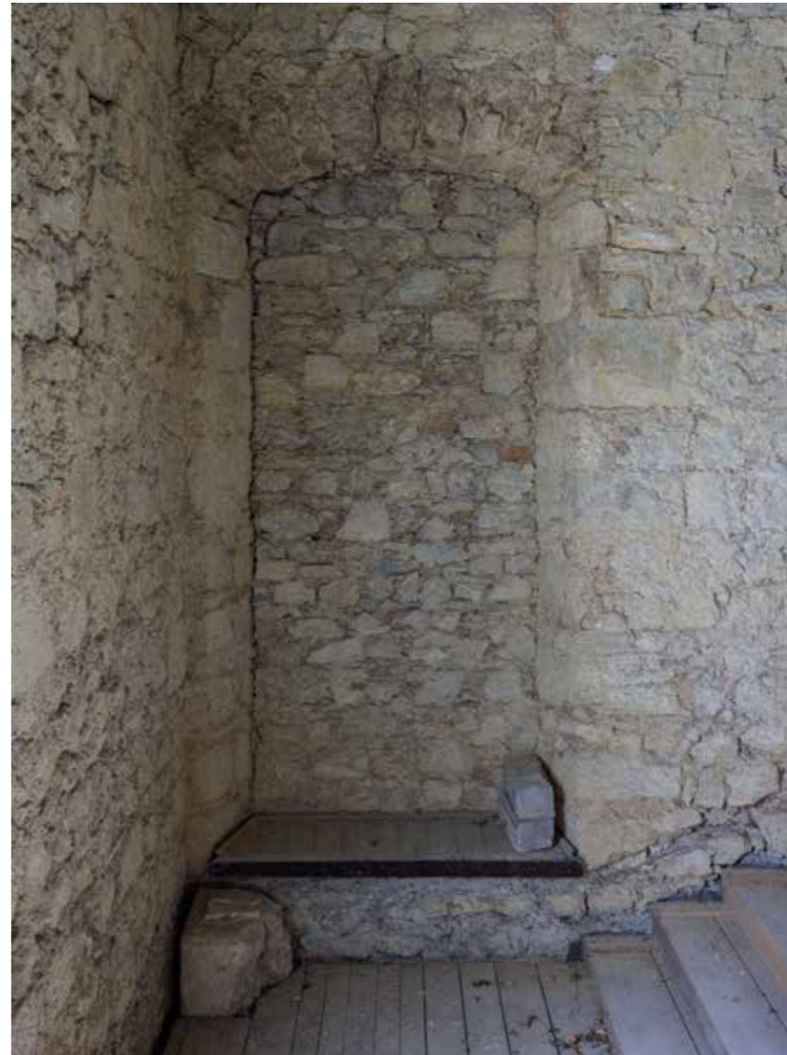
Zazidana ništa prolaza u južnom zidu stubišta
