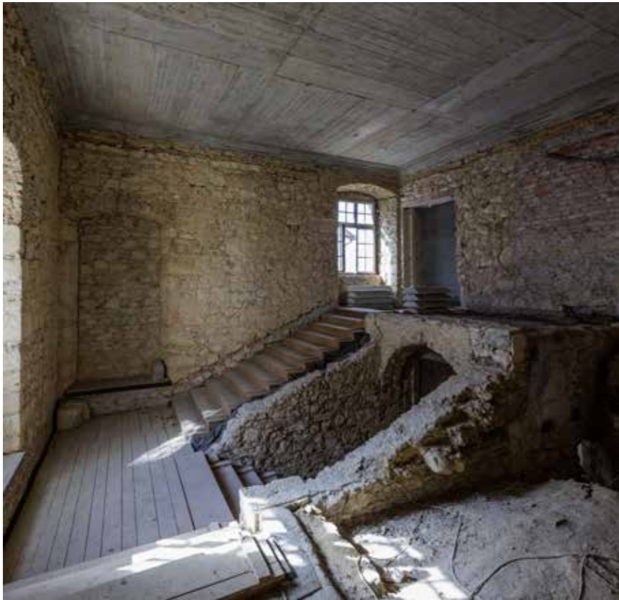
Djelomično razgrađeno trokrako stubište na drugom katu
