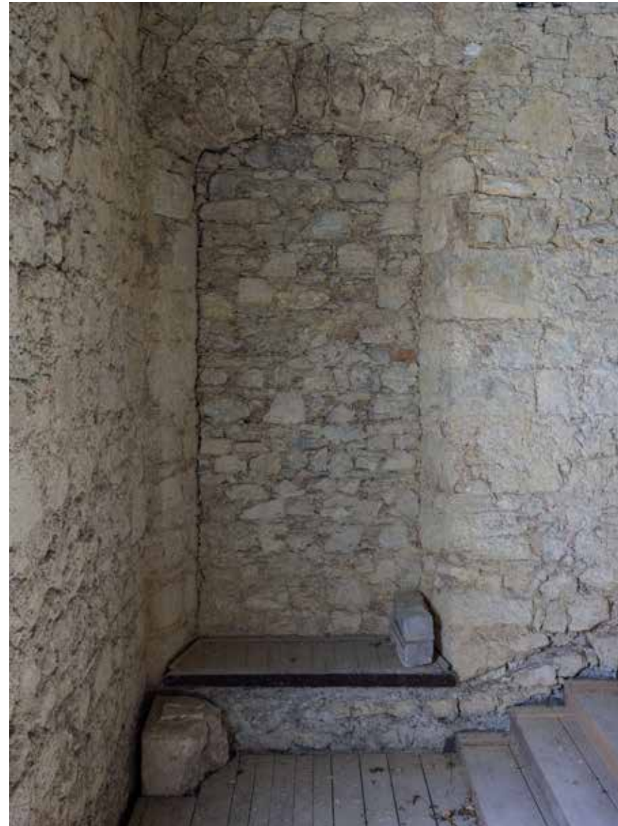
Zazidana ništa prolaza u južnom zidu stubišta
