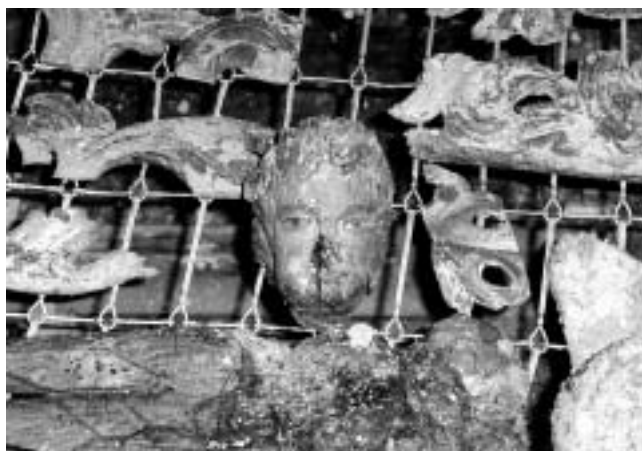
Kamensko, Pavlinski samostan — detalji oštećenih oltara. Crkva demolirana, srušeni svodovi i toranj za okupacije. Obnavlja Hrvatski restauratorski zavod. (Foto: Konzervatorski odjel Karlovac, 1996.)
