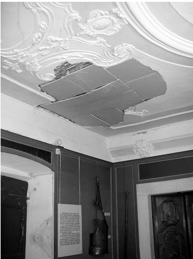
8. Oštećenja na stropu u stalnom postavu Muzeja grada Trogira, nakon izrezivanja stropa prije završene zaštitne sanacije.
