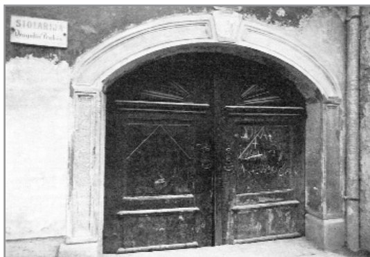
Tkalčičeva 24, kameni portal popravljen cementnom žbukom
