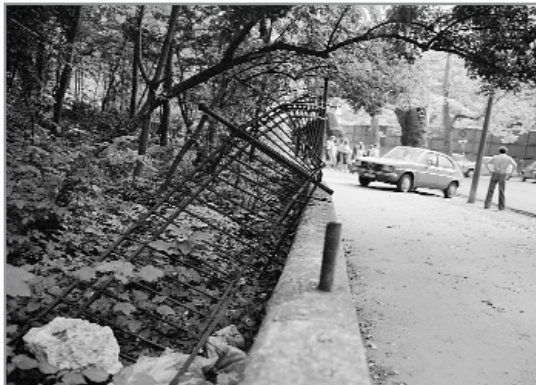
Tuškanac, srušena i zapuštena željezna ograda gornjogradske palače
